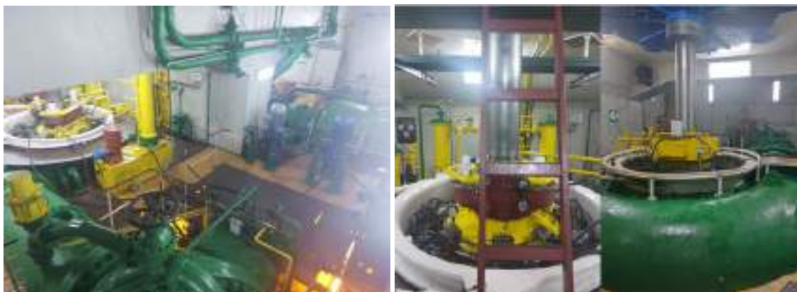
Slika 3.8 –HE „Vrla 3“ predturbinski zatvarači i turbine I i II faze
