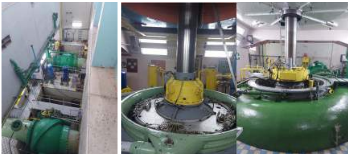
Slika 3.6 –HE „Vrla 2“ predturbinski zatvarači i turbine I i II faze
