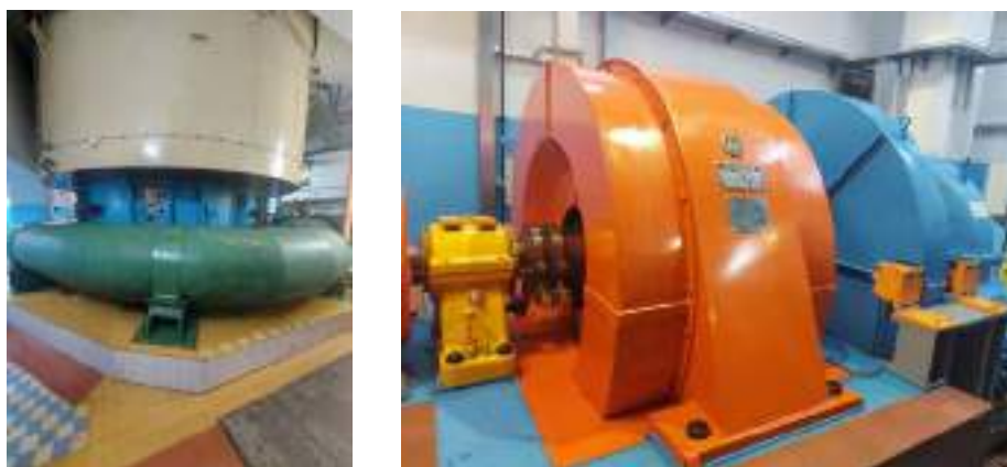
Slika 3.4 –HE „Vrla 1“ turbine i pomoćni agregat
