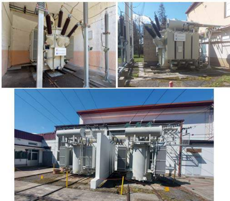
Slika 7.2 –Blok transformatori u HE „Vrla 1,3 i 4”
