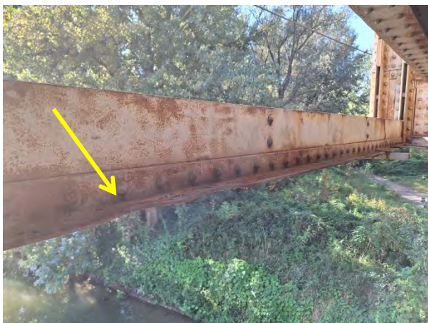
Деформација доње ножице доњег појаса на 2.5m од чвора 0'
