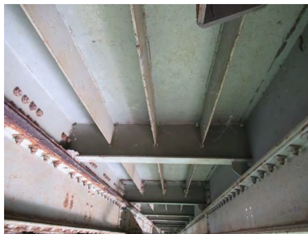
Тачкаста површинска корозија - десни монтажни комад орто-плоче
