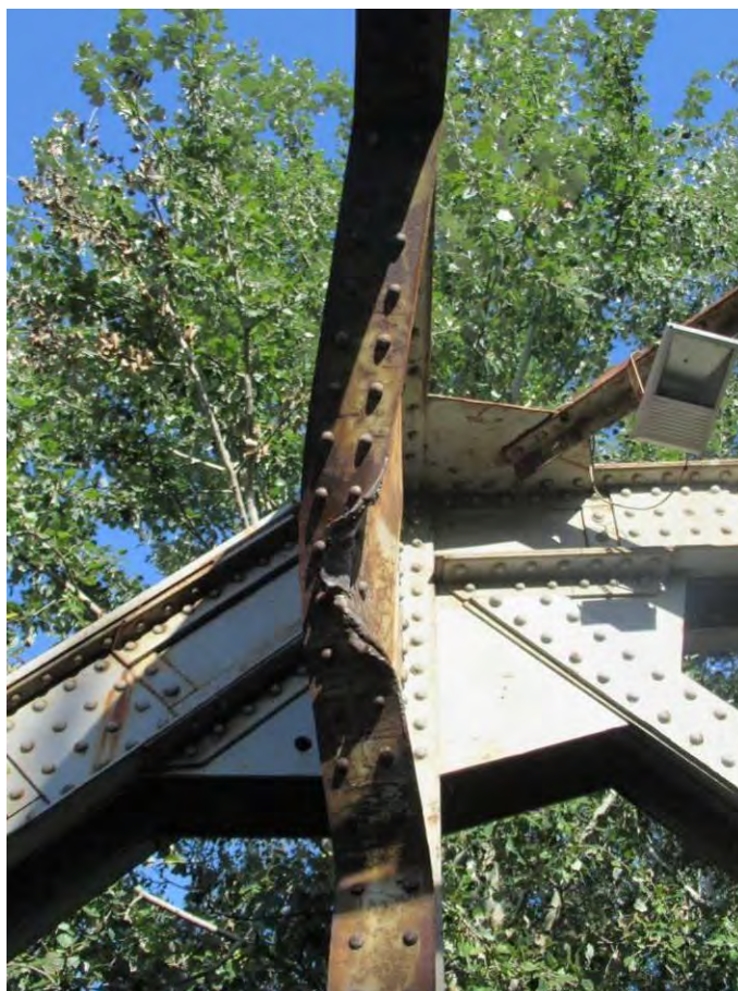
Механичко оштећење левог укрућења улазног портала конструкције К2
