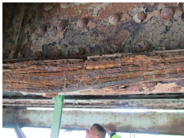
Изузетно лоше стање монтажног наставка носача 4 у пољу 1-2
