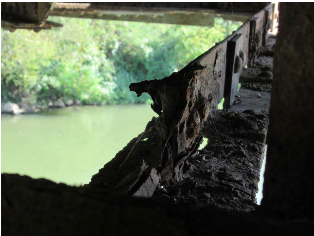
Веће оштећење дијагонале доњег спрега за ветар у пољу 3'-2'
