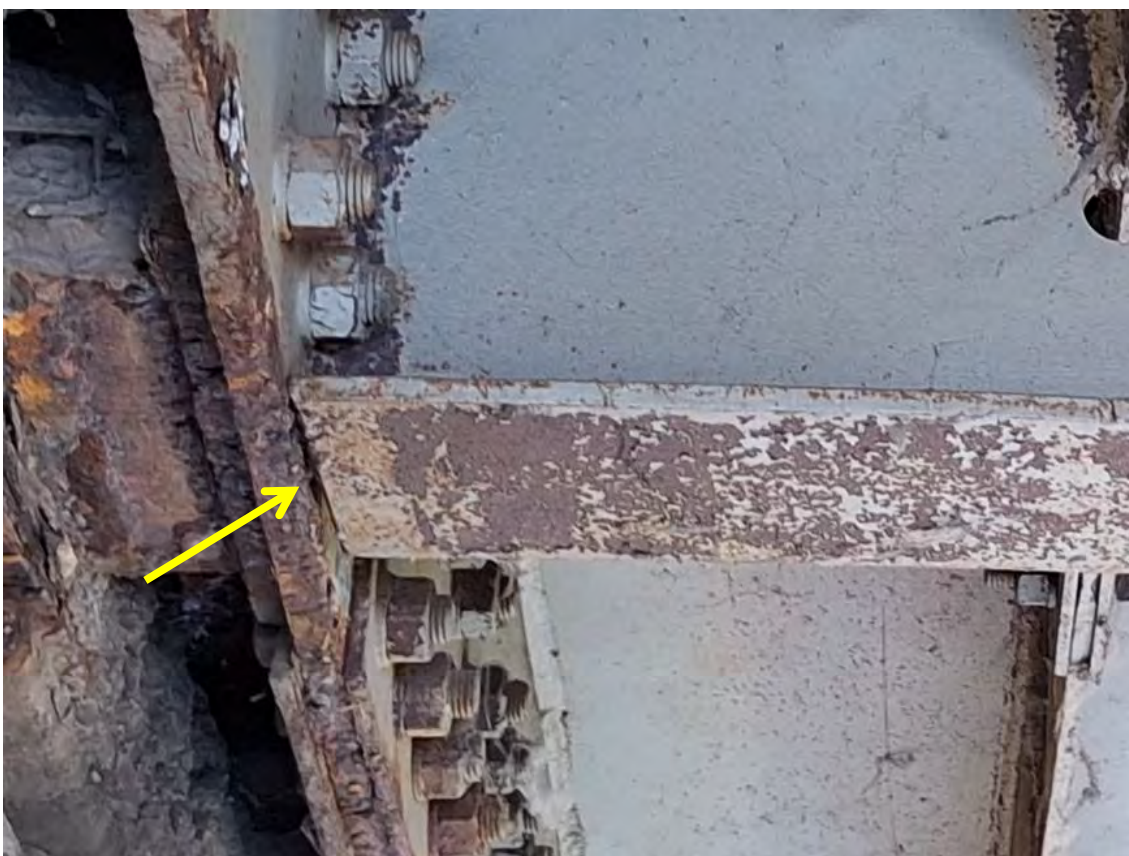
Незаварена доња фланша попречног укрућења за подужно укрућење
