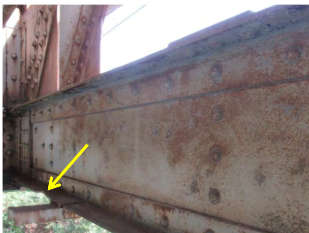
Локална деформација доње ножице - узводна решетка, поље 1-2
