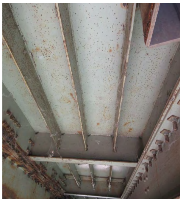
Тачкаста површинска корозија - десни монтажни комад орто-плоче
