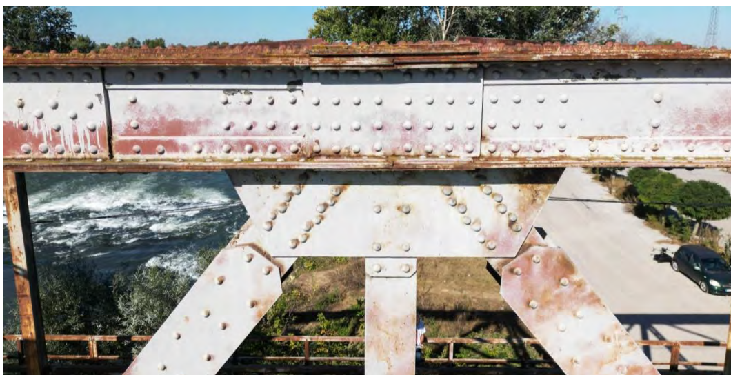
Местимична површинска корозија бочних површина горњег појаса конструкције K4
