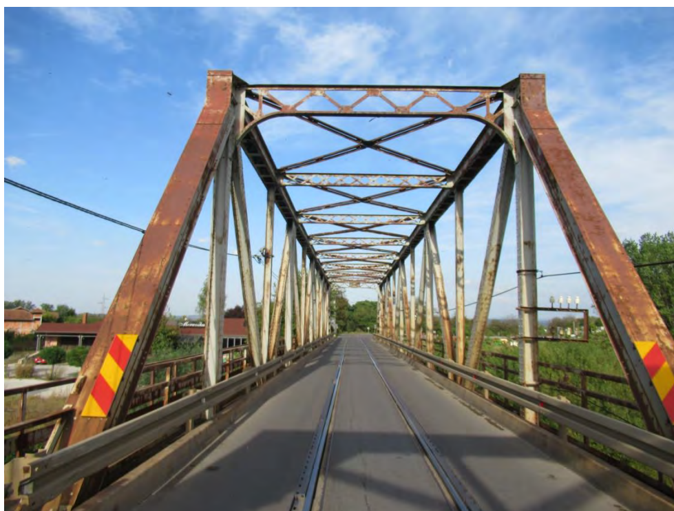
Површинска корозија горње површине крајњих дијагонала конструкције К4
