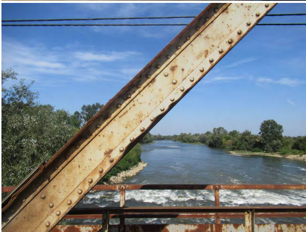
Механичка оштећења дијагонале 0-1 левог решеткастог носача конструкције КЗ
