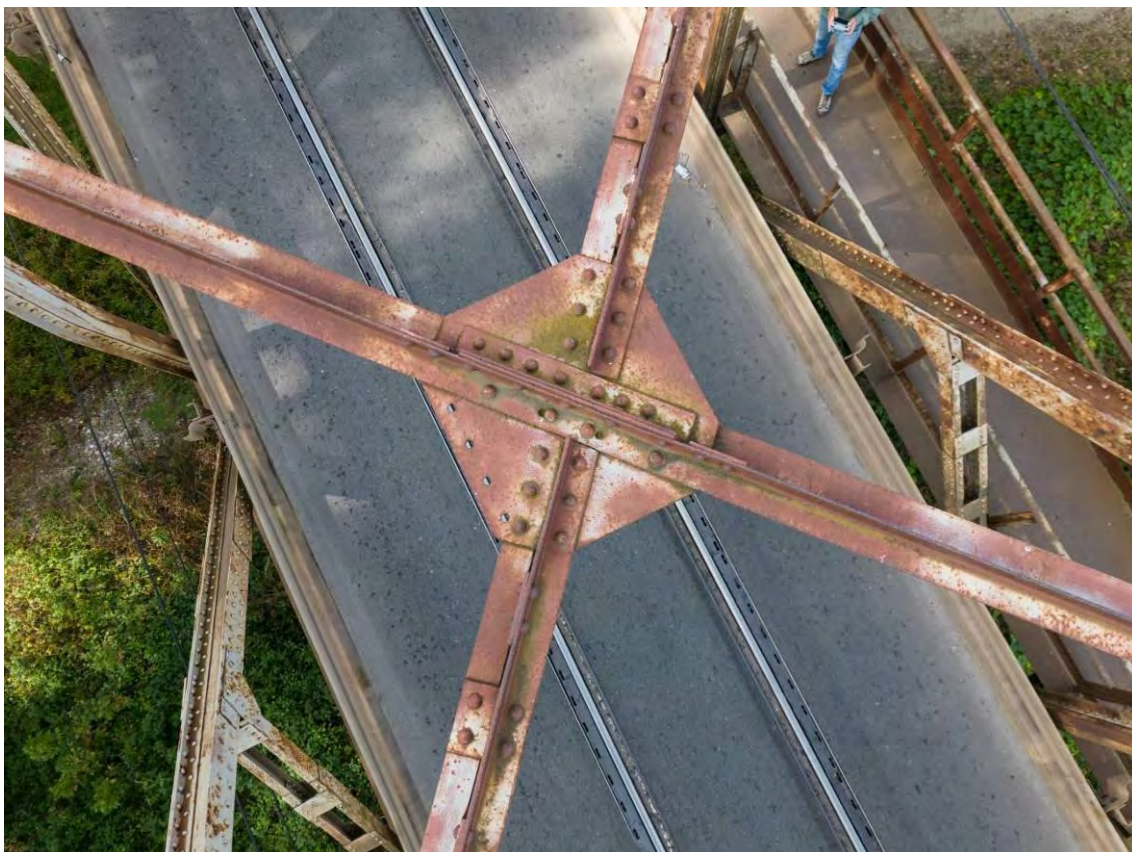
Површинска корозија горње површине дијагонала и чворног лима на месту укрштања дијагонала горњег спрега за ветар конструкције K2
