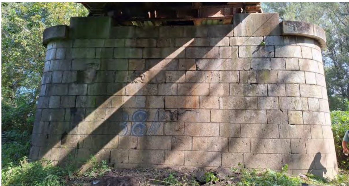
Трагови сливања воде, незапуњене фуге на телу стуба
