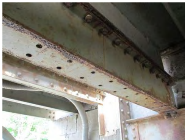
Подужни носач захваћен површинском корозијом
