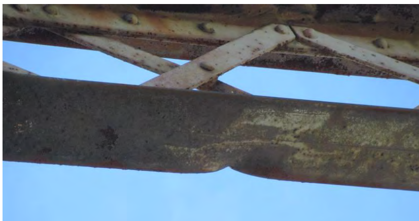
Механичка оштећења доње зоне две вертикале горњег спрега за ветар конструкције К4
