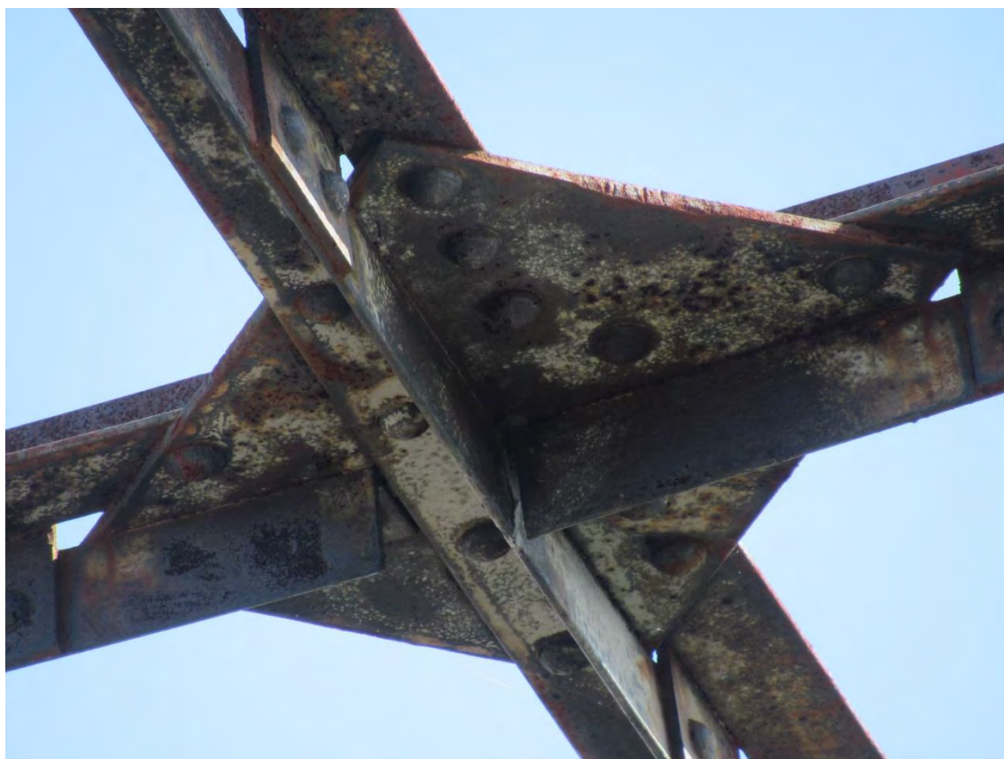
Површинска корозија доње површине штапова и чворног лима на месту укрштања дијагонала горњег спрега за ветар конструкције K4
