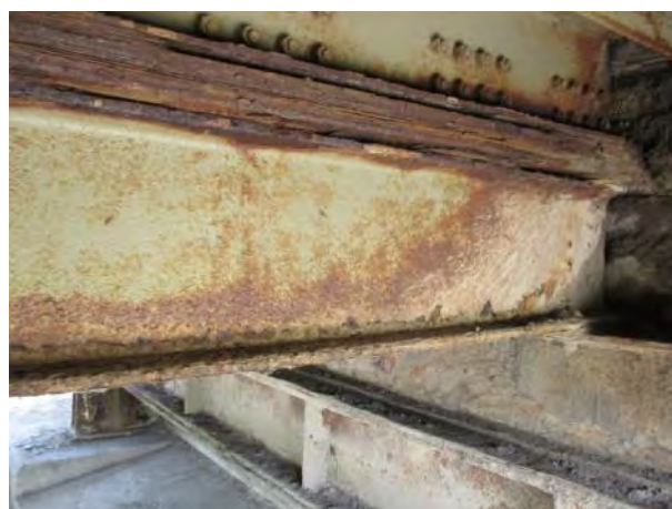
Ламеле између подужног носача и ортотропне плоче деформисане услед корозије
