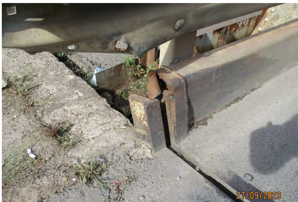
Оштећење левог ивичњака на почетку моста
