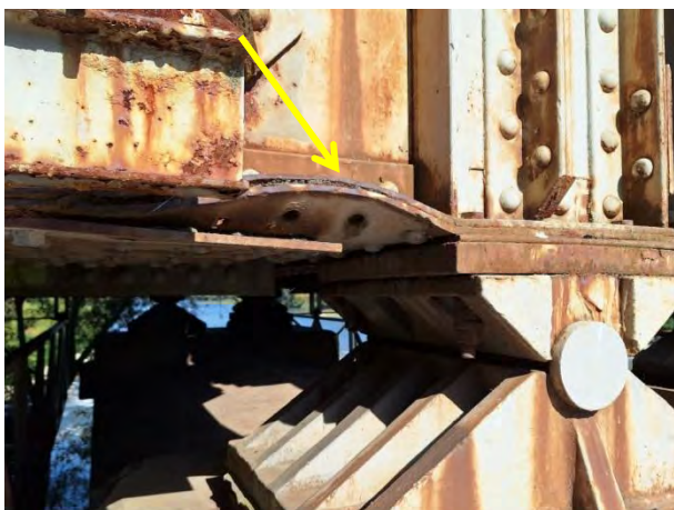
Деформација доње ножице доњег појаса у чвору 0'
