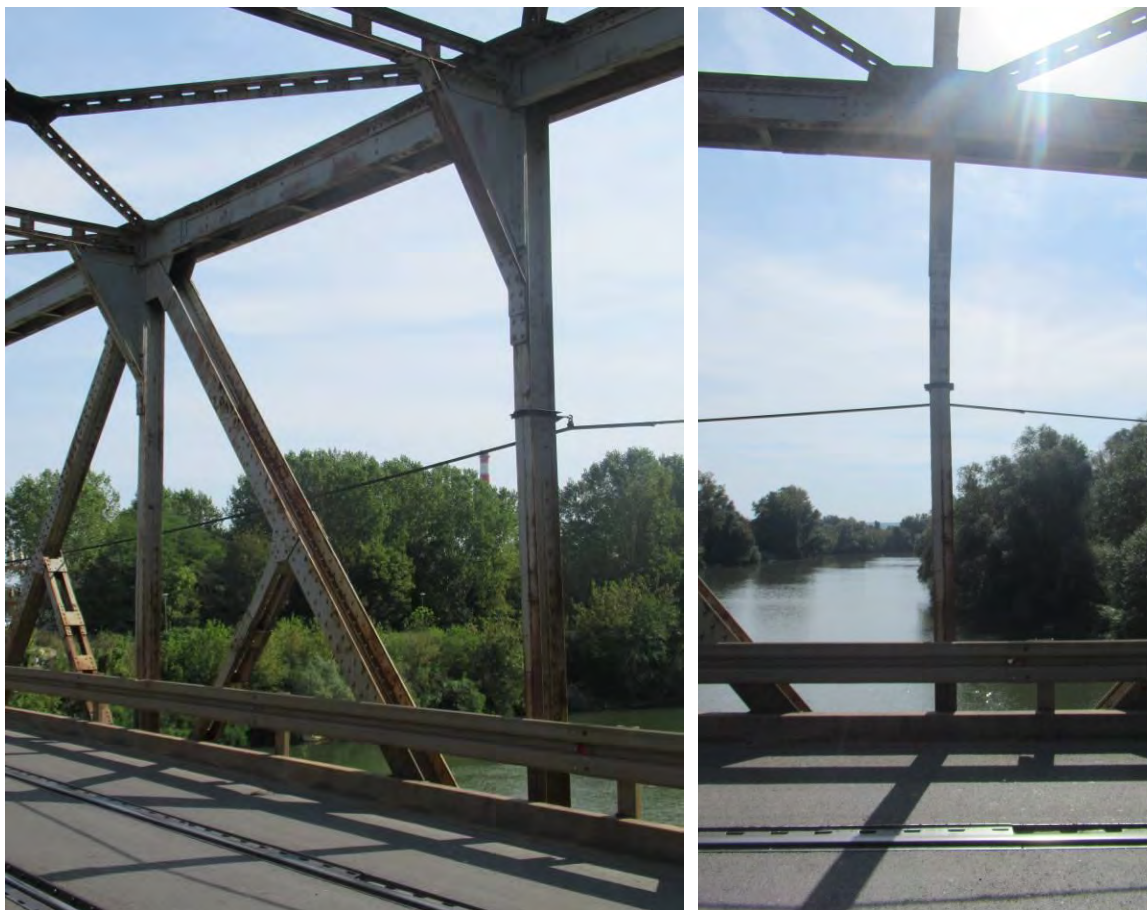
Механичко оштећење вертикале II десног решеткастог носача конструкције КЗ
