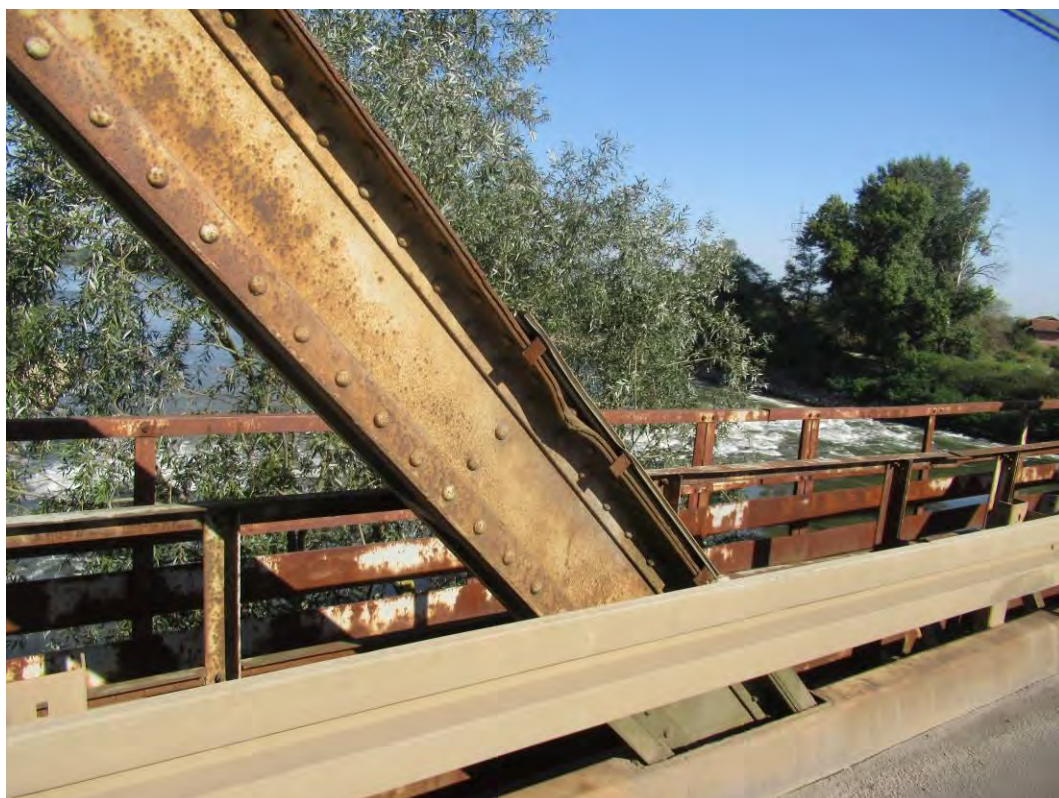
Механичка оштећења дијагонале I'-0' левог решеткастог носача конструкције K2
