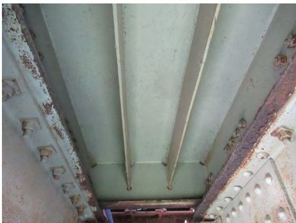
Тачкаста површинска корозија - средњи монтажни комад орто-плоче
