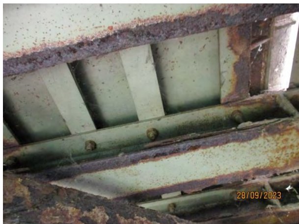
Тачкаста површинска корозија - средњи монтажни комад орто-плоче
