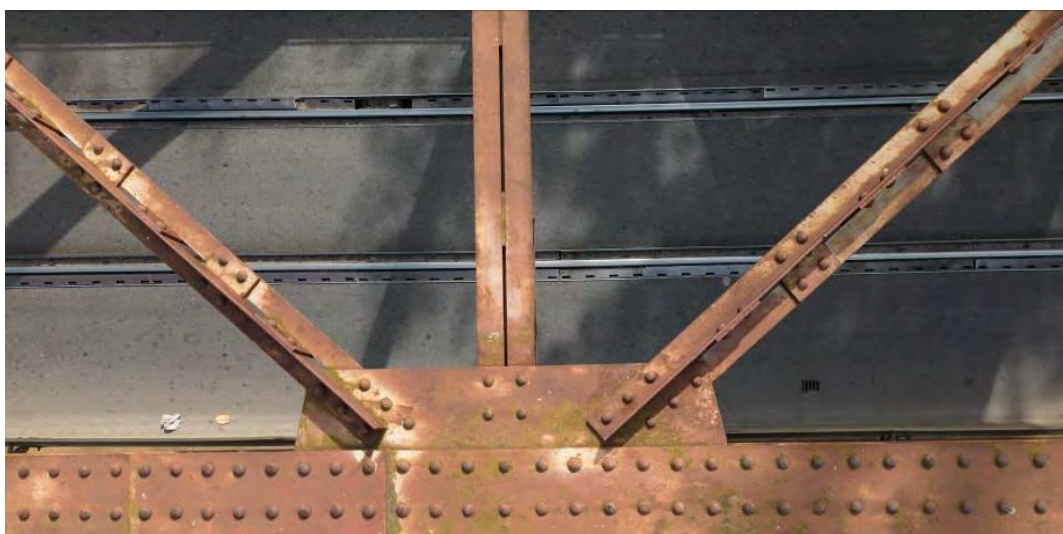
Површинска корозија штапова и чворног лима горњег спрега за ветар конструкције K1
