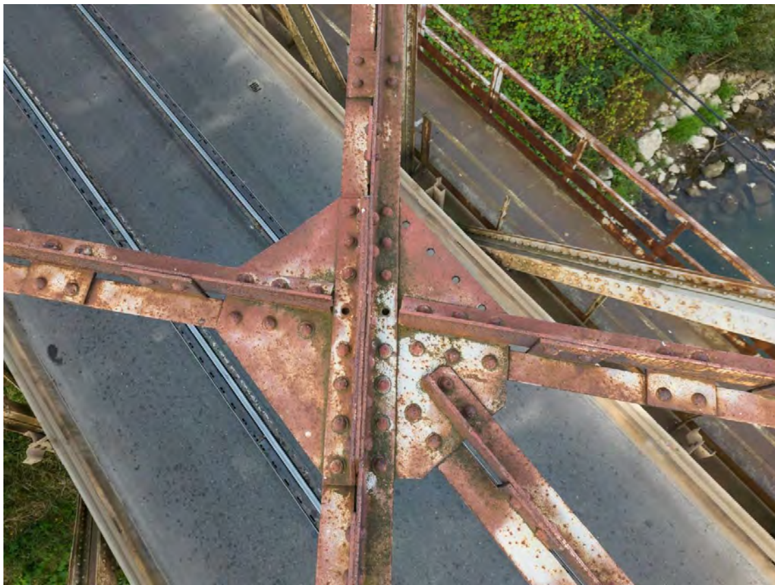
Површинска корозија горње површине штапова и чворног лима на месту укрштања дијагонала горњег спрега за ветар у крајњем пољу конструкције K2
