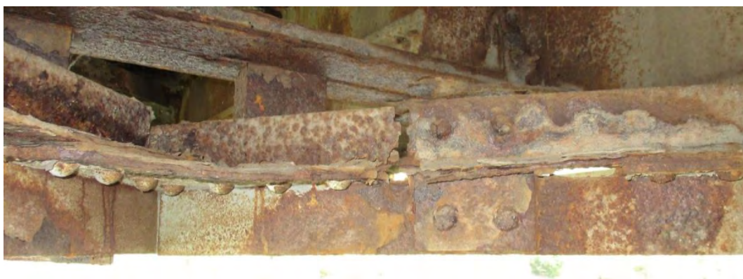
Веће оштећење дијагонале доњег спрега за ветар у пољу 2-3
