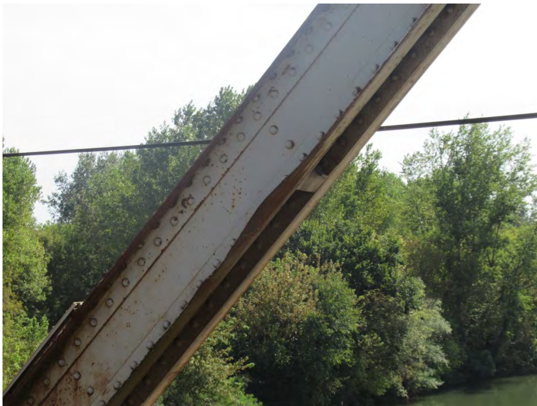
Механичка оштећења дијагонале I'-0' десног решеткастог носача конструкције К3
