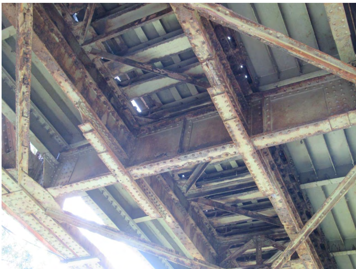
Дубинска корозија коловозне потконструкције моста - конструкција К3
