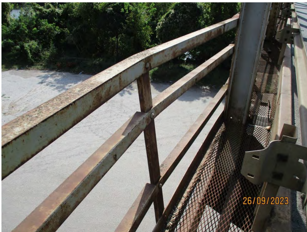
Искривљен стуб десне ограде на конструкцији К4
