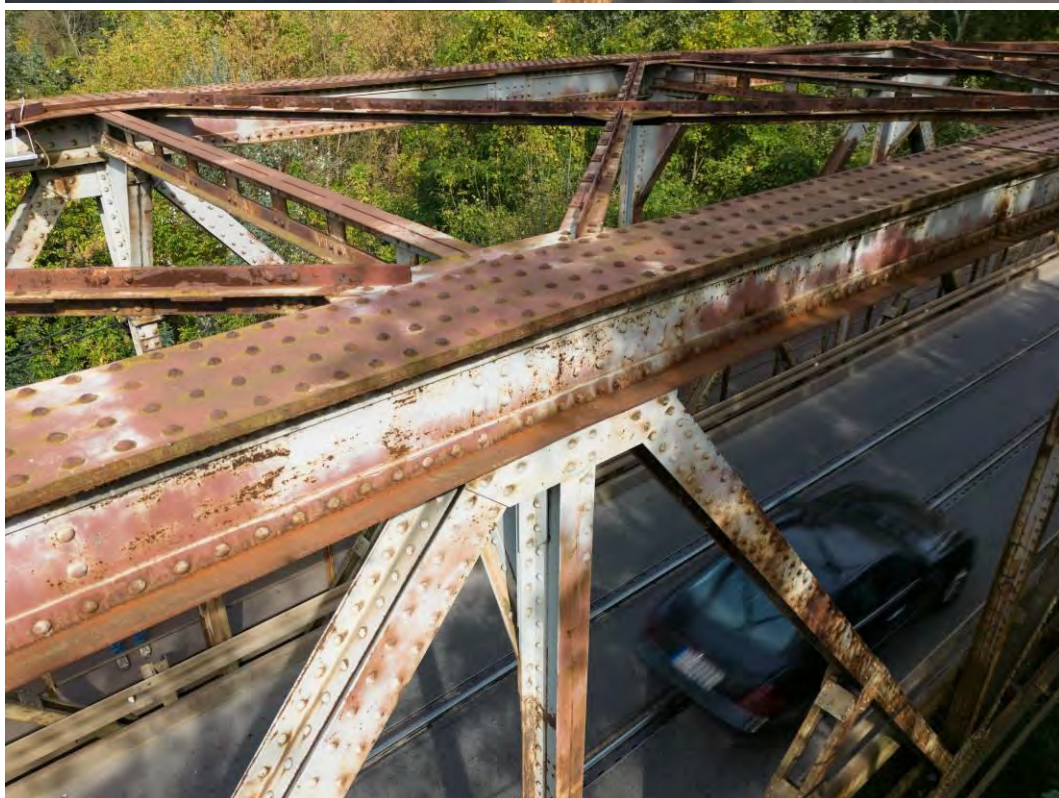
Површинска корозија бочних површина горњег појаса конструкције К1
