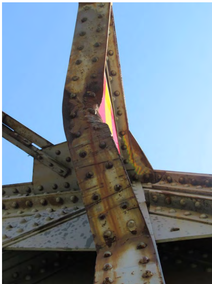
Механичко оштећење десног укрућења улазног порталног рама конструкције К1
