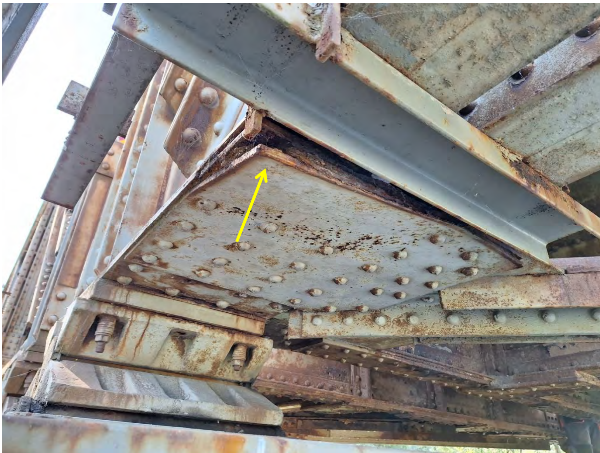
Деформисана ламела на доњем појасу
