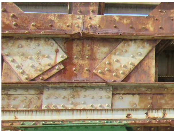
Чворови доњег појаса - генерално у добром стању, захваћени површинском корозијом
