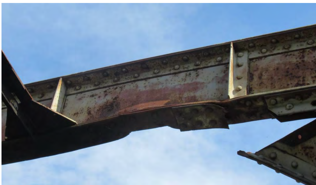
Механичко оштећење горње ригле излазног порталног рама конструкције К3
