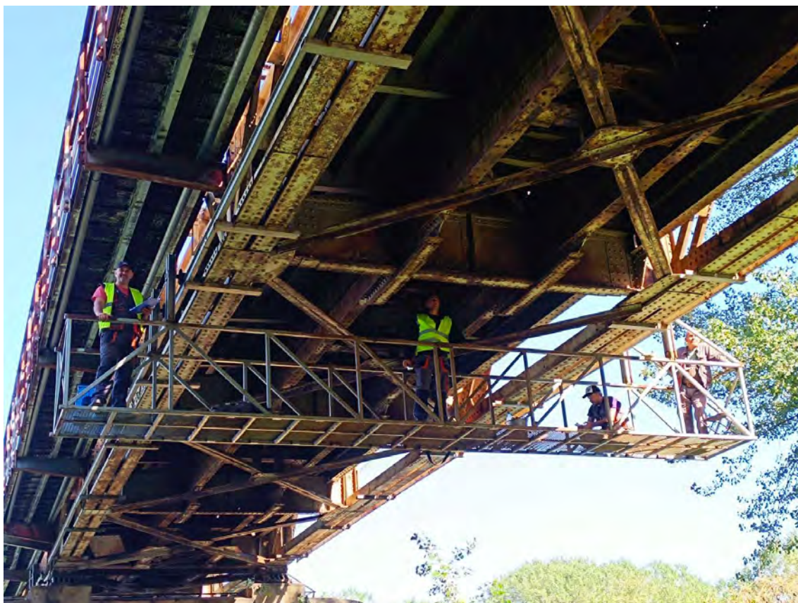
Дубинска корозија коловозне потконструкције моста - конструкција К1
