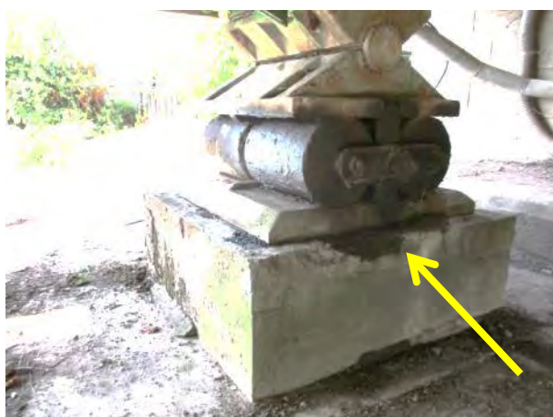
Оштећење квадера левог лежишта
