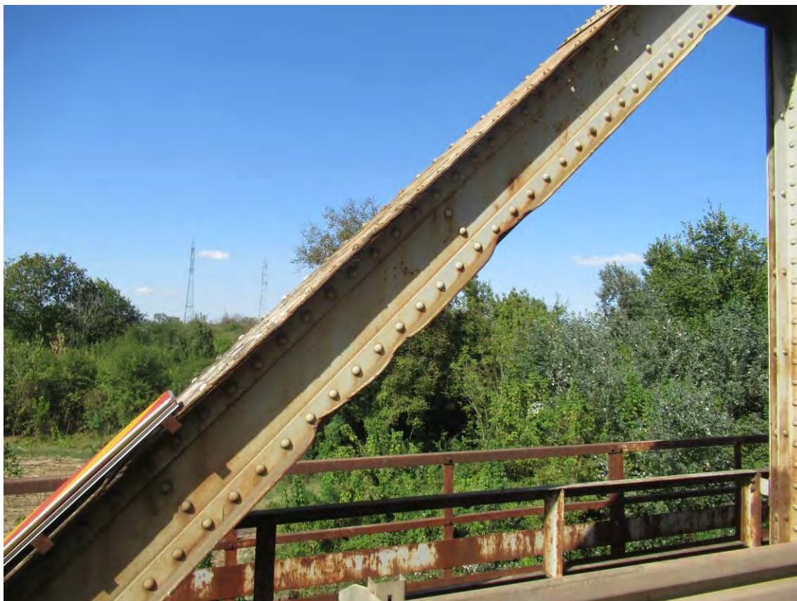
Механичка оштећења дијагонале 0-I левог решеткастог носача конструкције K1
