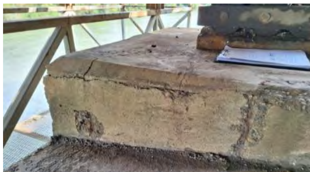
Оштећење квадера испод десног лежишта
