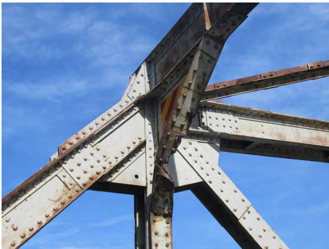
Механичко оштећење левог укрућења улазног портала конструкције КЗ
