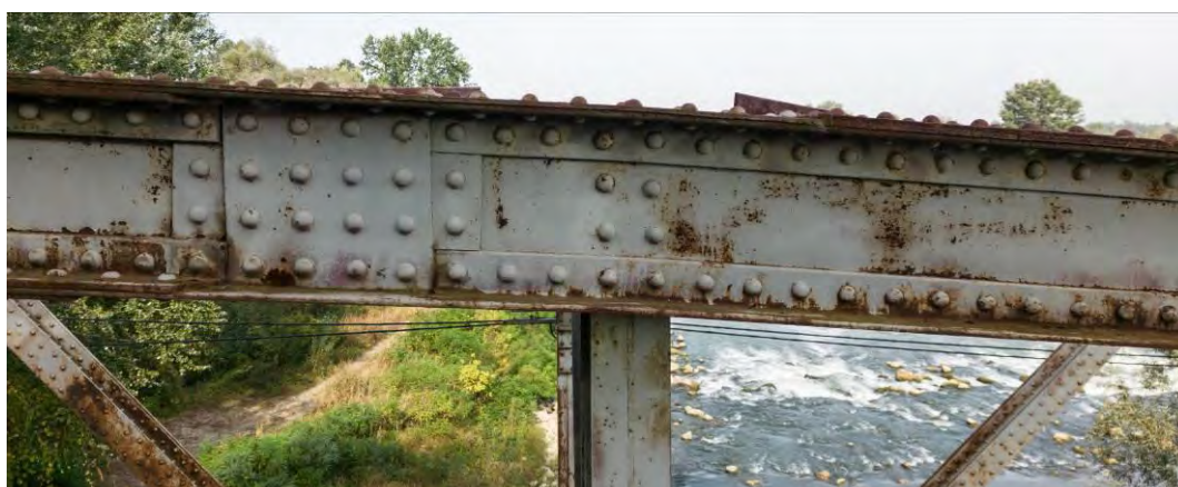
Местимична површинска корозија бочних површина горњег појаса конструкције K2
