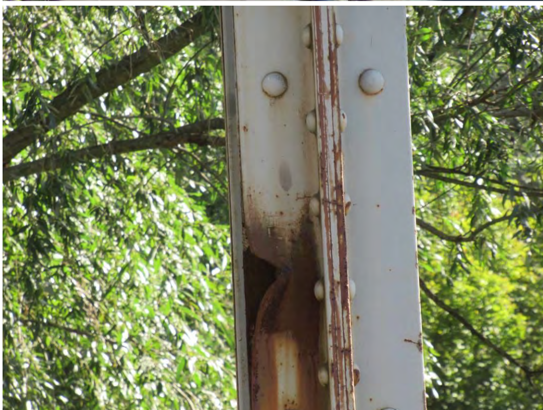
Механичко оштећење прве (порталне) вертикале десног решеткастог носача конструкције К1
