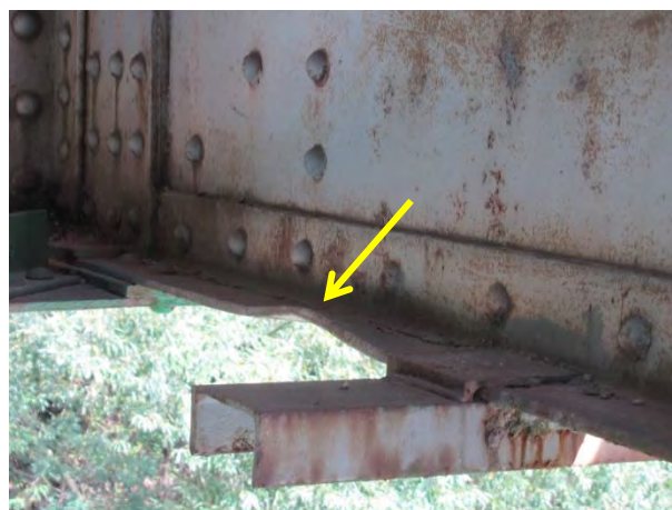
Локална деформација доње ножице - узводна решетка, поље 1-2
