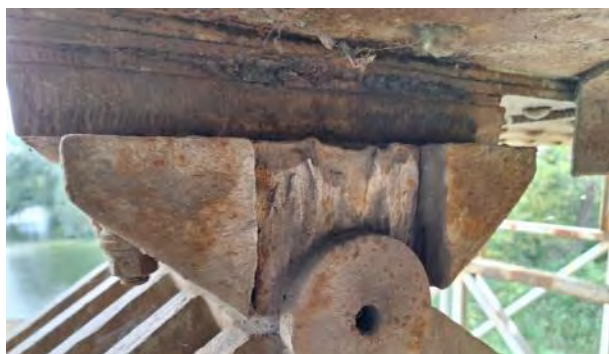
Трагови неправилног сечења горње лежишне плоче.
