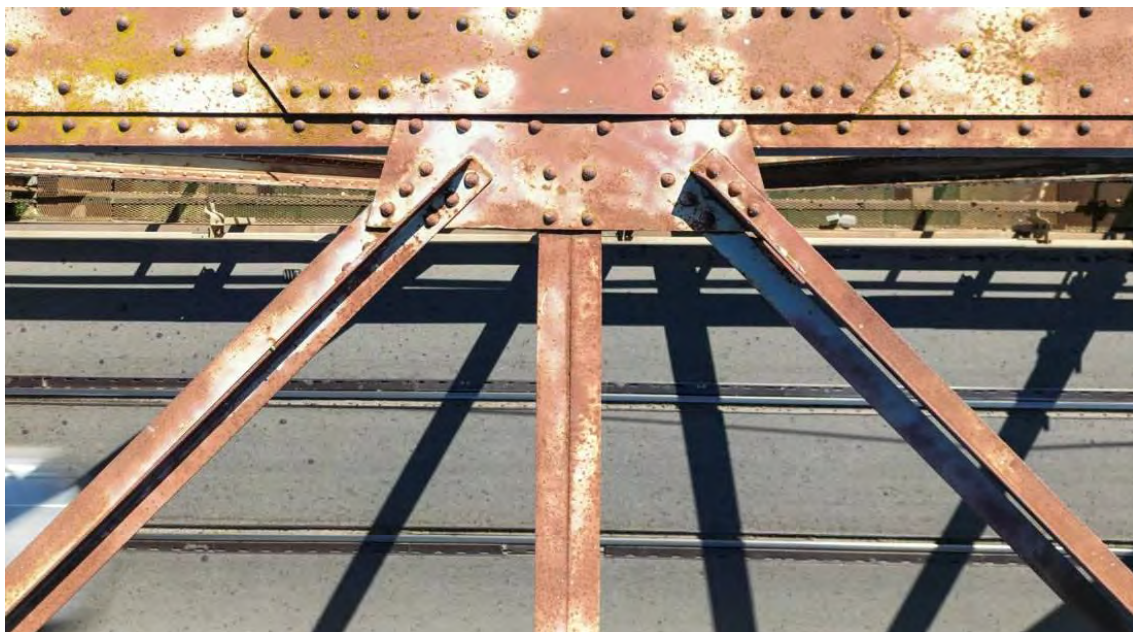
Површинска корозија штапова и чворног лима горњег спрега за ветар конструкције К4
