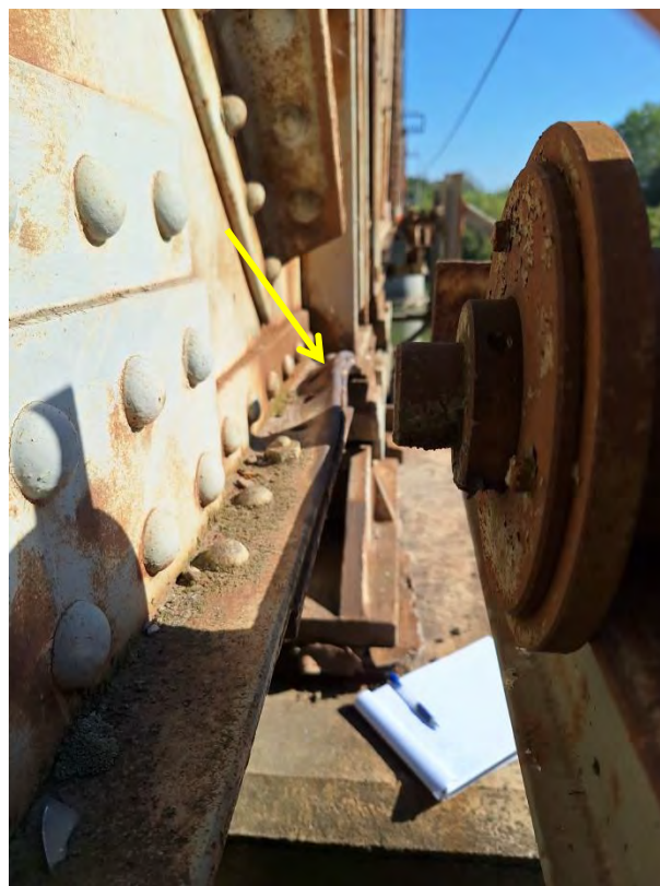
Деформација доње ножице доњег појаса у чвору 0'
