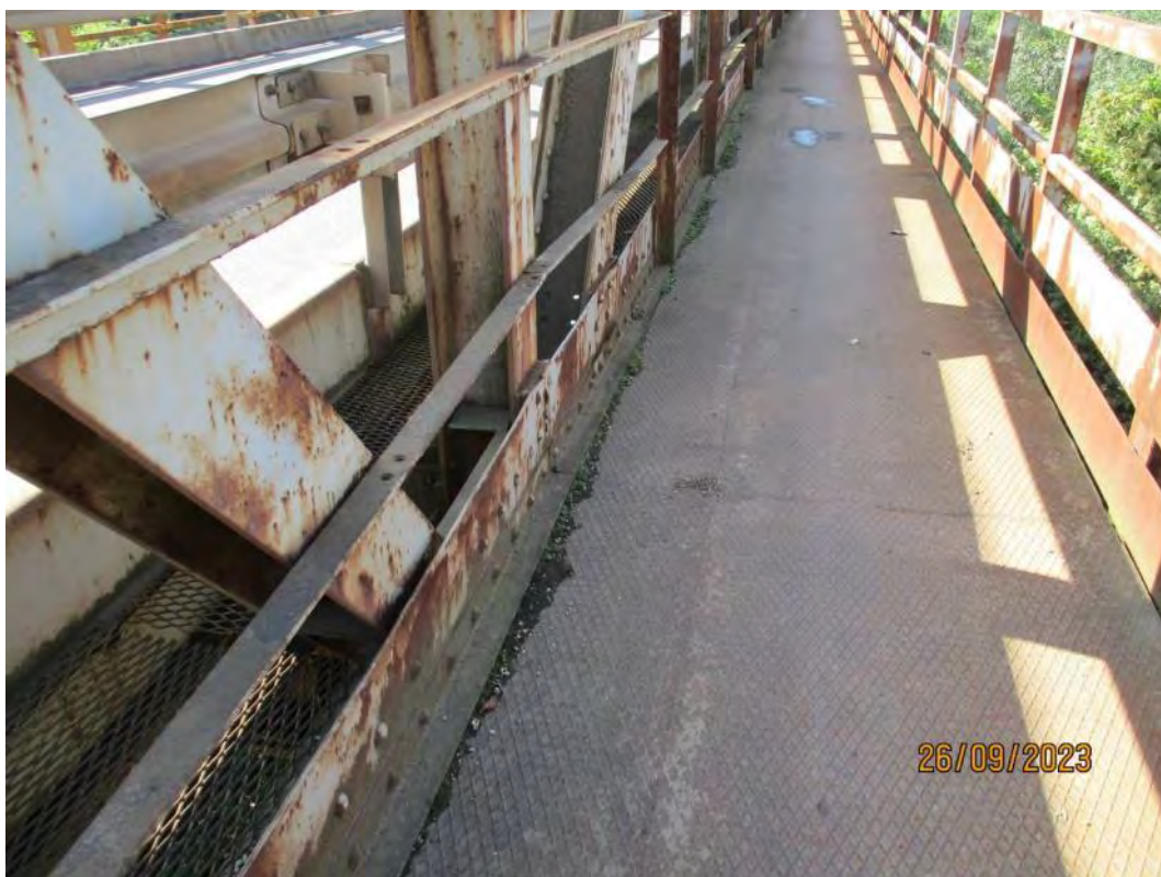
Локално појава маховине уз унутрашњу ограду пешачке стазе
