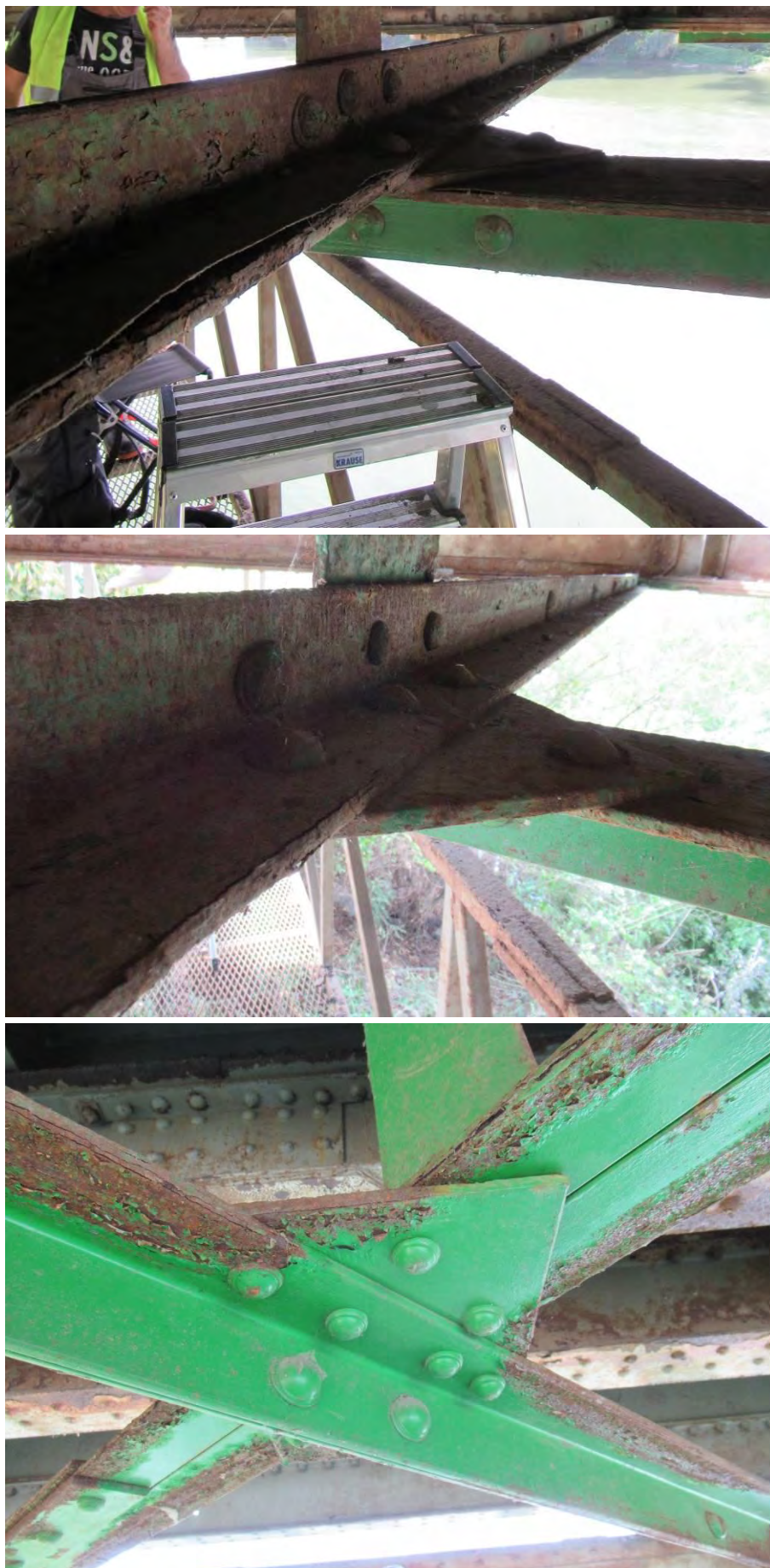
Површинска корозија и љуспање премаза доњег спрега конструкције K4
