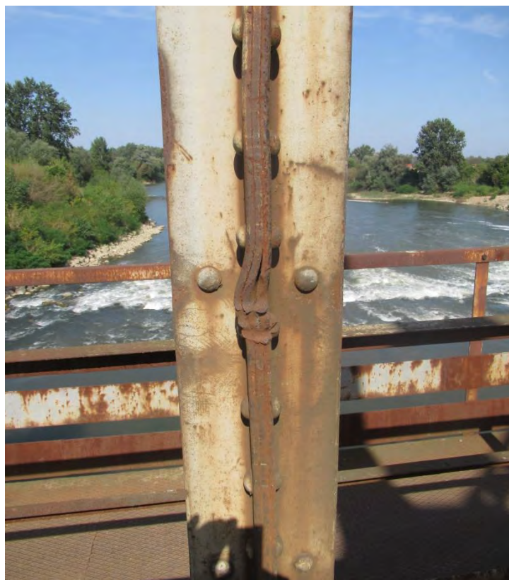
Механичко оштећење вертикале I левог решеткастог носача конструкције КЗ
