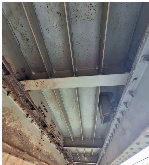
Тачкаста површинска корозија - десни монтажни комад орто-плоче
