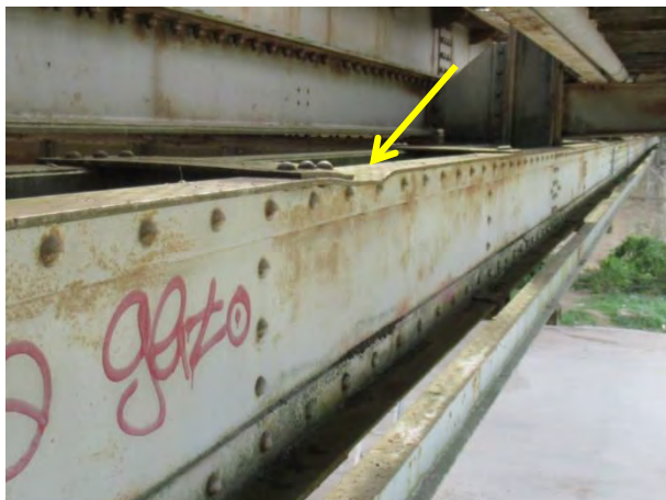
Локална деформација горње ножице - низводна решетка, поље 1'-0'
