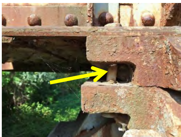
Деформисани завртњеве на споју две горње лежишне плоче. Десно лежиште
