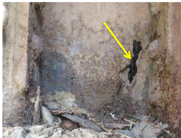
Деградација услед дубинске корозије ребра вертикале узводне решетке у чвору 2
