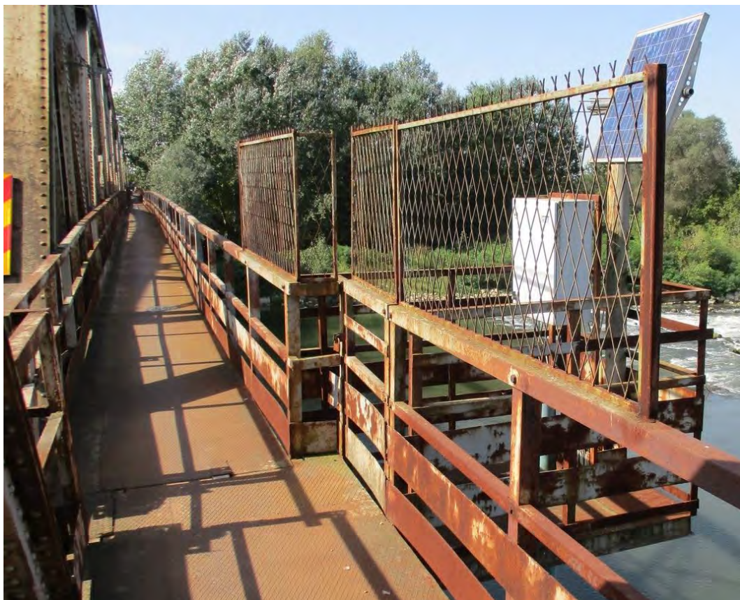
Смакнута ограда и заштитна мрежа заварена на рукохват спољне ограде пешачке стазе код средњег стуба моста С4
