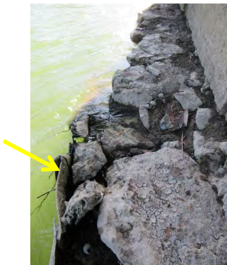
Оштећен лим око темељног проширења и деградација темеља
