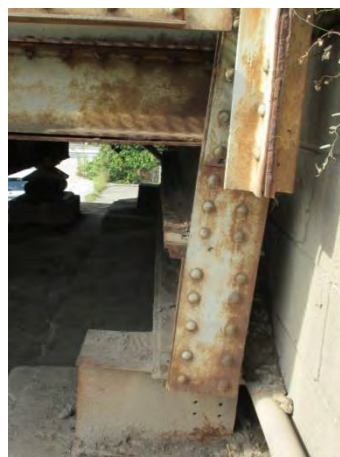
Деформација ослоначке конструкције
