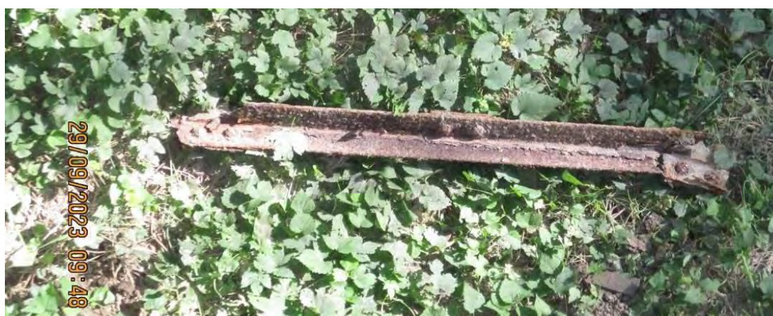
Прекинута дијагонала спрега за кочење у првом пољу конструкције К2
