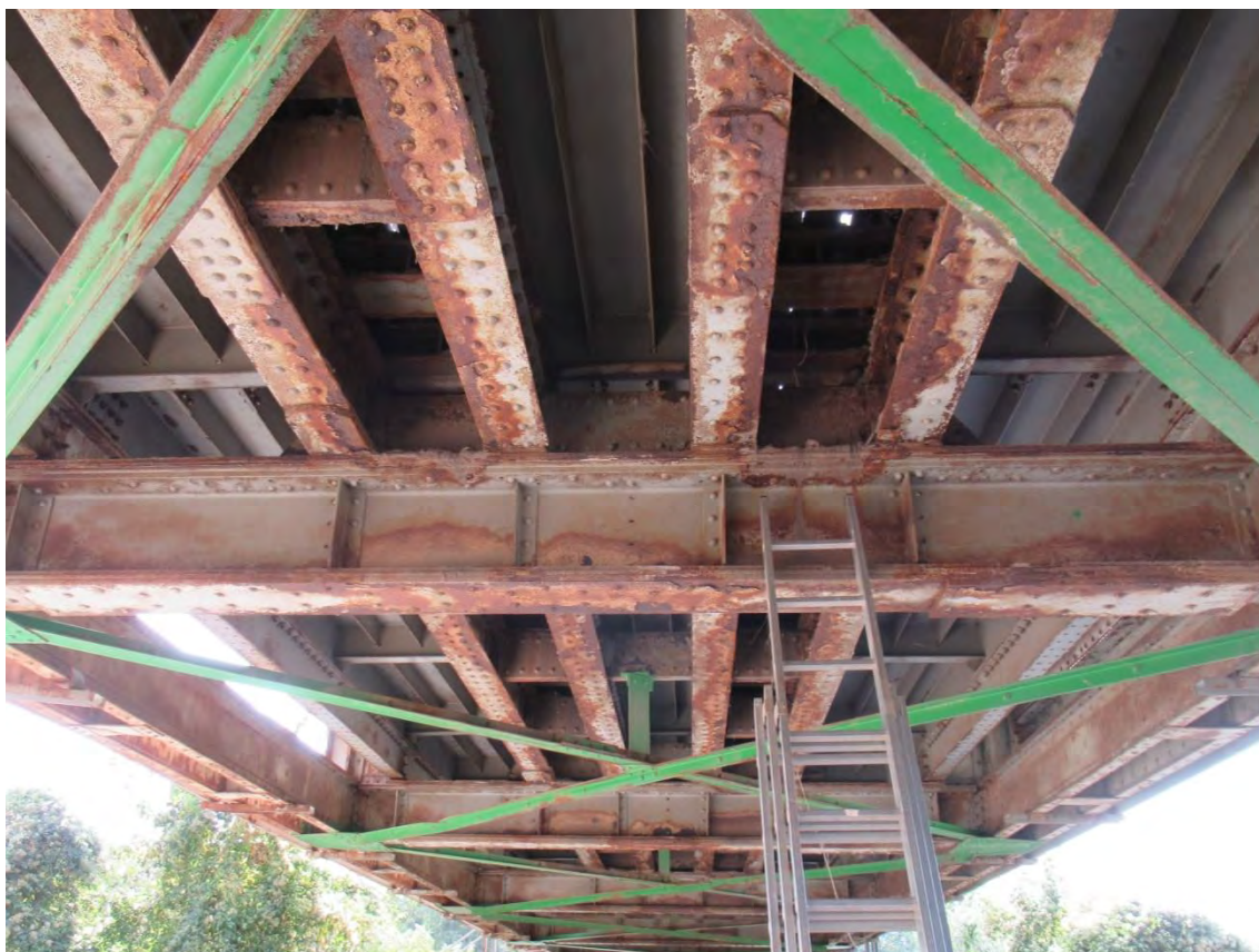
Дубинска корозија коловозне потконструкције моста - конструкција К4
