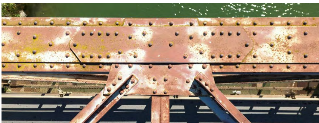
Местимична површинска корозија горњих површина елемената горњег појаса конструкције К4
