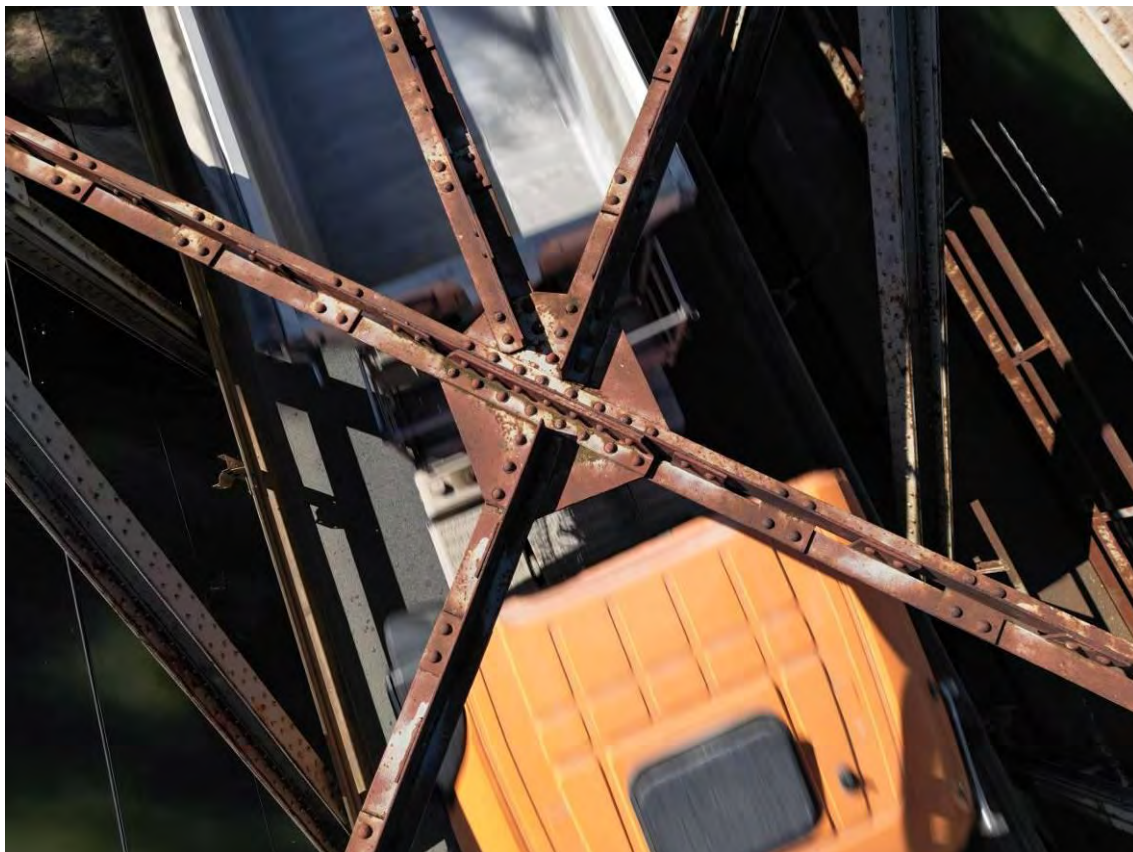
Површинска корозија горње површине штапова и чворног лима на месту укрштања дијагонала горњег спрега за ветар у крајњем пољу конструкције КЗ
