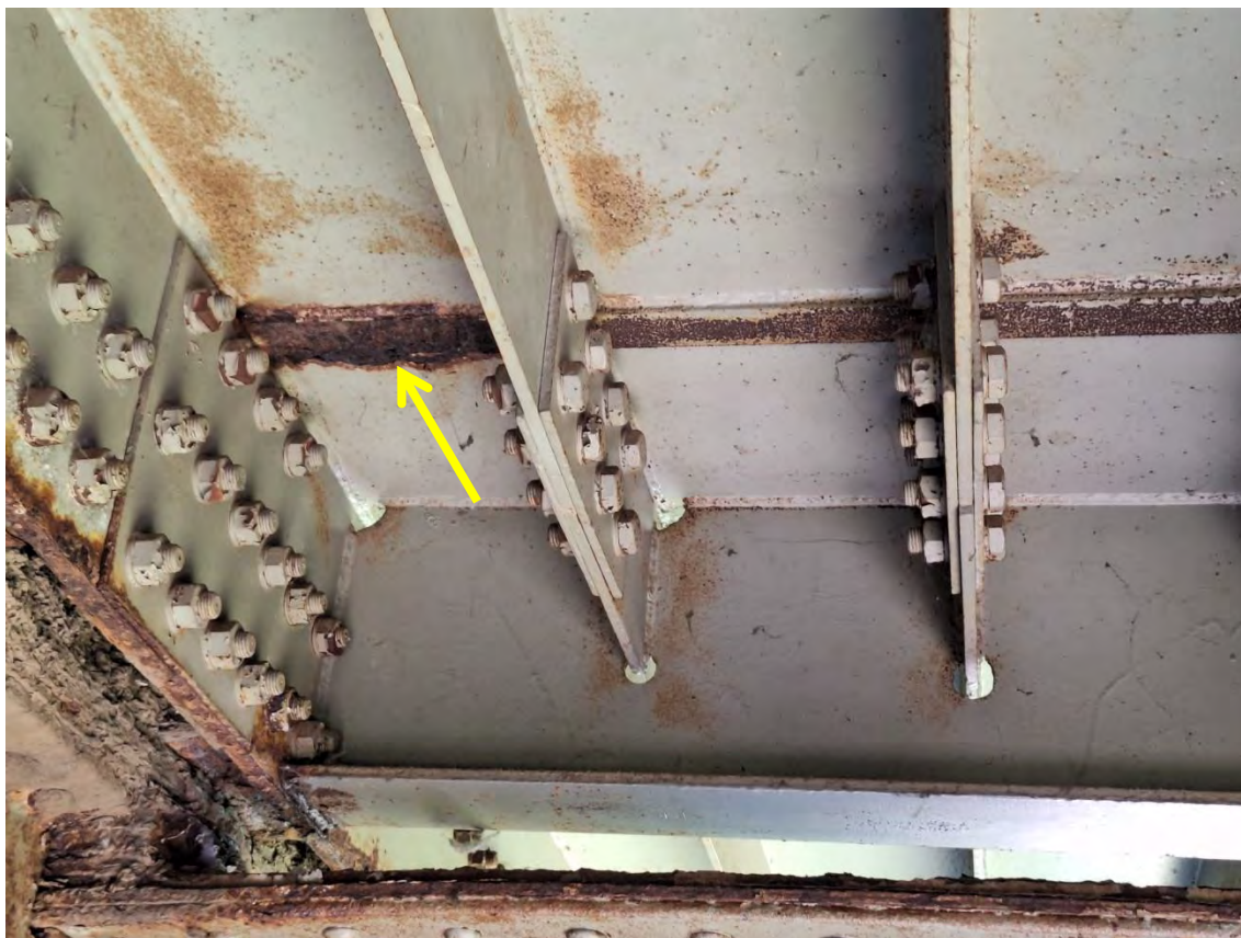
Трагови процуривања на месту монтажнoг наставка у пољу 4-5
