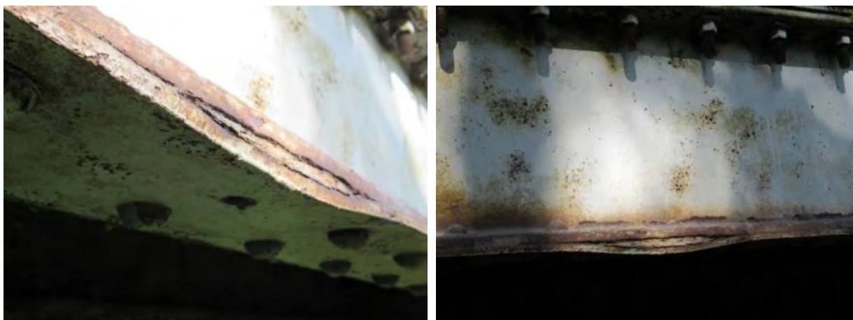
Недостатак заковице на вези доње ламеле са деформацијом доње ламеле услед корозије, узводни носач, поље 3'-2'
