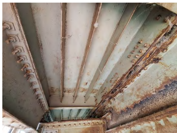
Тачкаста површинска корозија - десни монтажни комад орто-плоче
