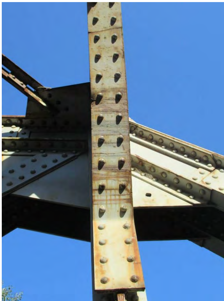
Механичко оштећење левог укрућења излазног порталног рама конструкције К1
