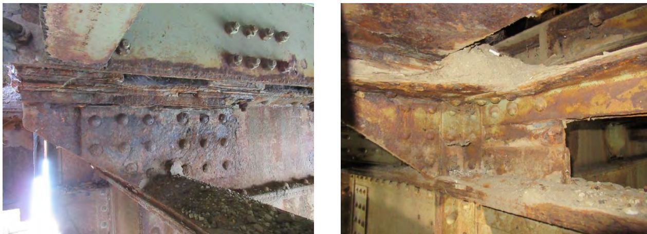
Дубинска корозија конзоле подужног носача
