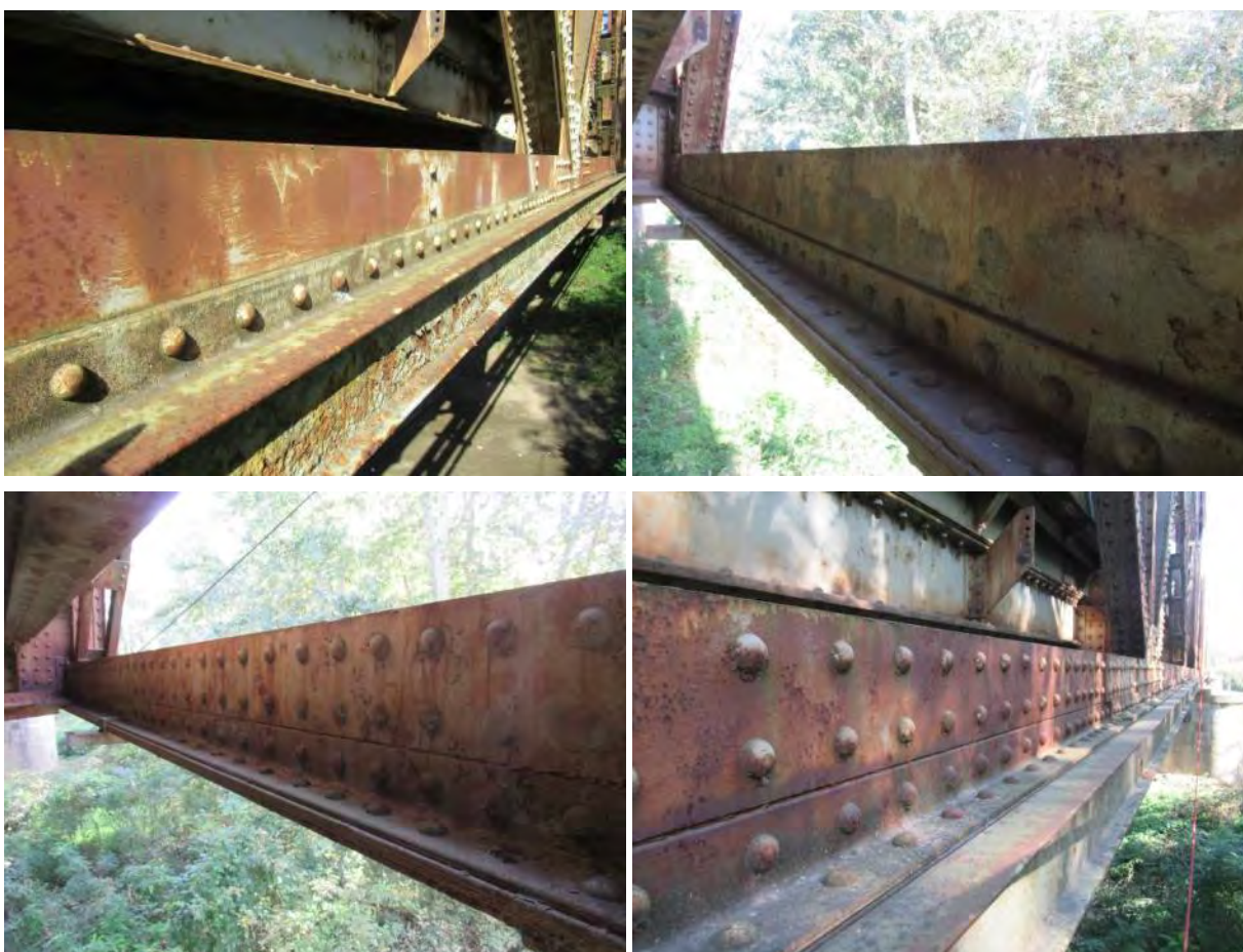
Штапови доњег појаса - генерално у добром стању, захваћени површинском корозијом
