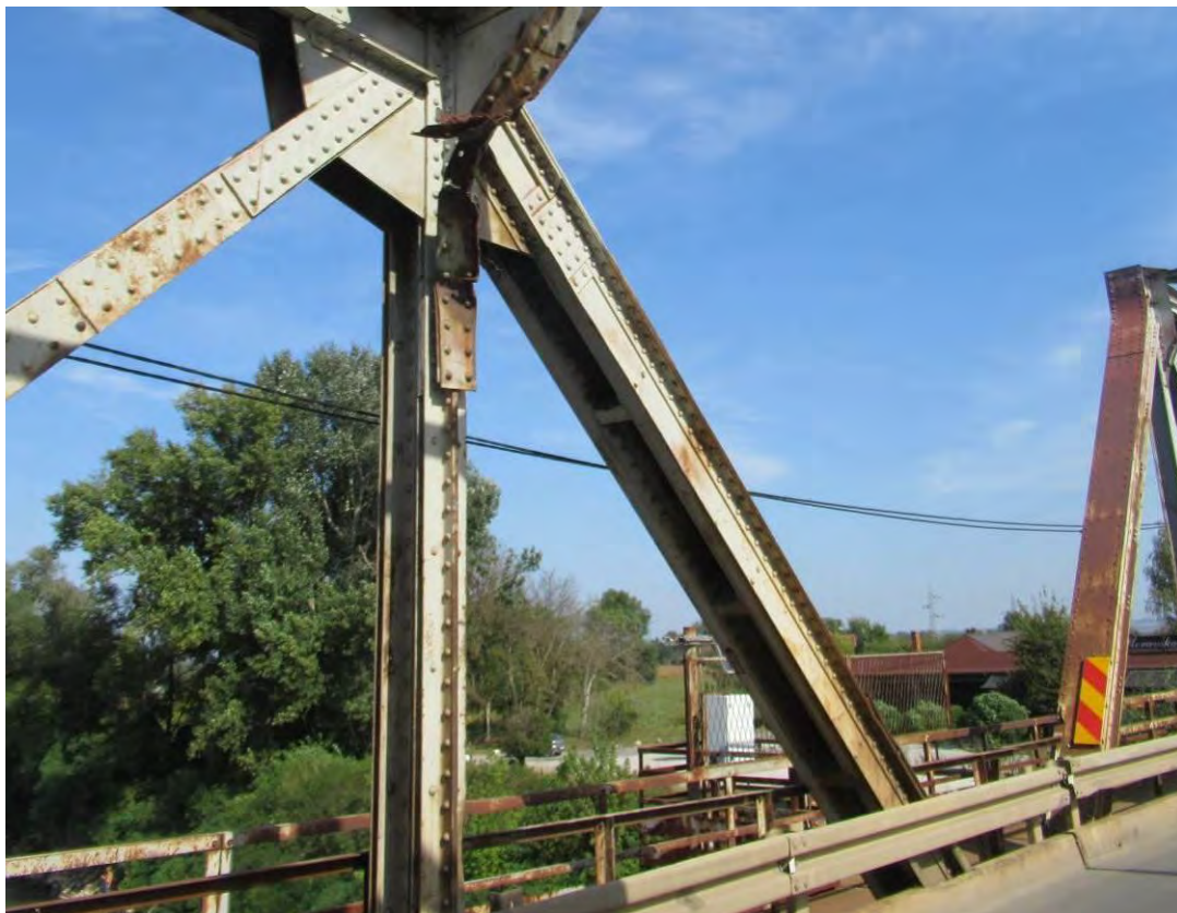
Механичко оштећење дијагонале I'-0' левог решеткастог носача конструкције К3
