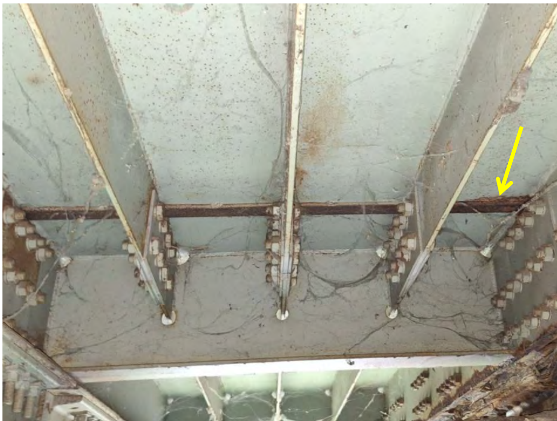
Трагови процуривања на месту монтажнoг наставка у пољу 1-2
