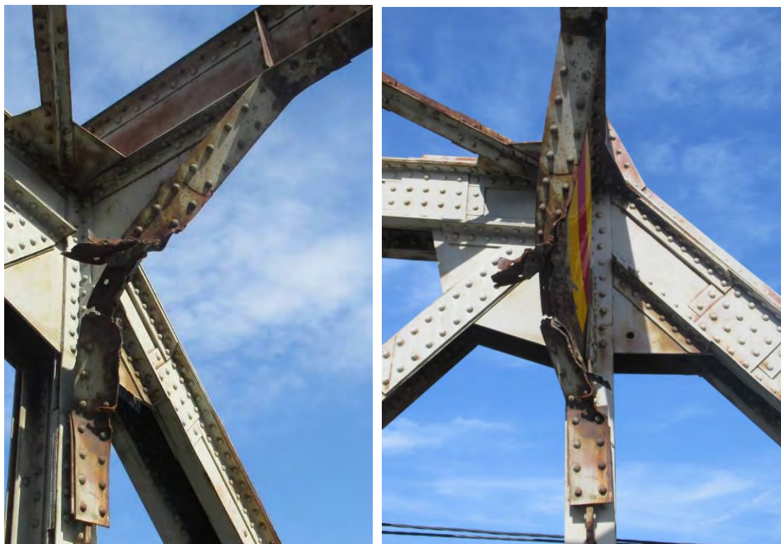
Механичко оштећење левог укрућења излазног порталног рама конструкције К3
