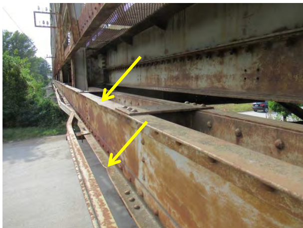
Локална деформација доње и горње ножице - узводна решетка, поље 1'-0'
