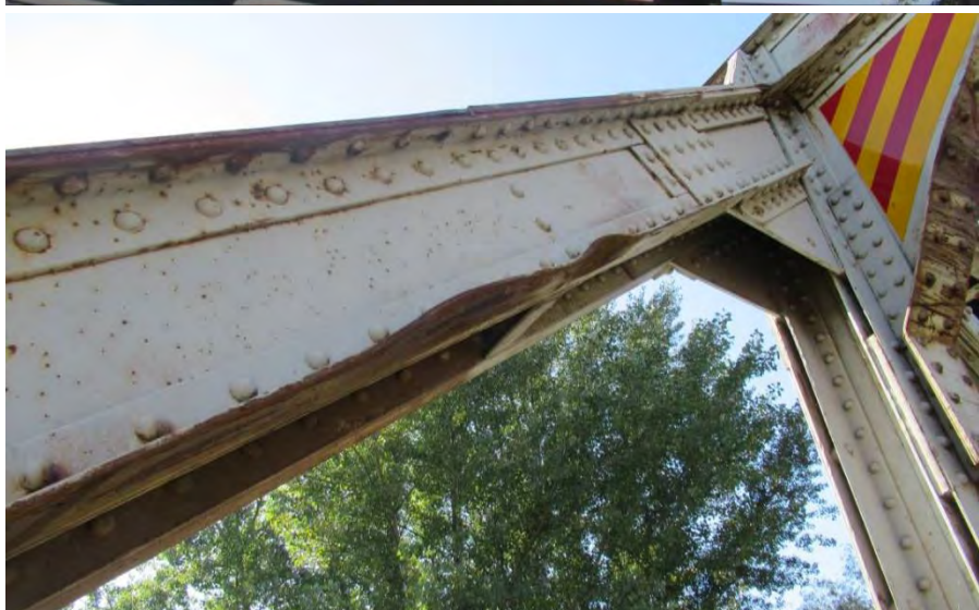
Механичка оштећења дијагонале I'-O' десног решеткастог носача конструкције K2
