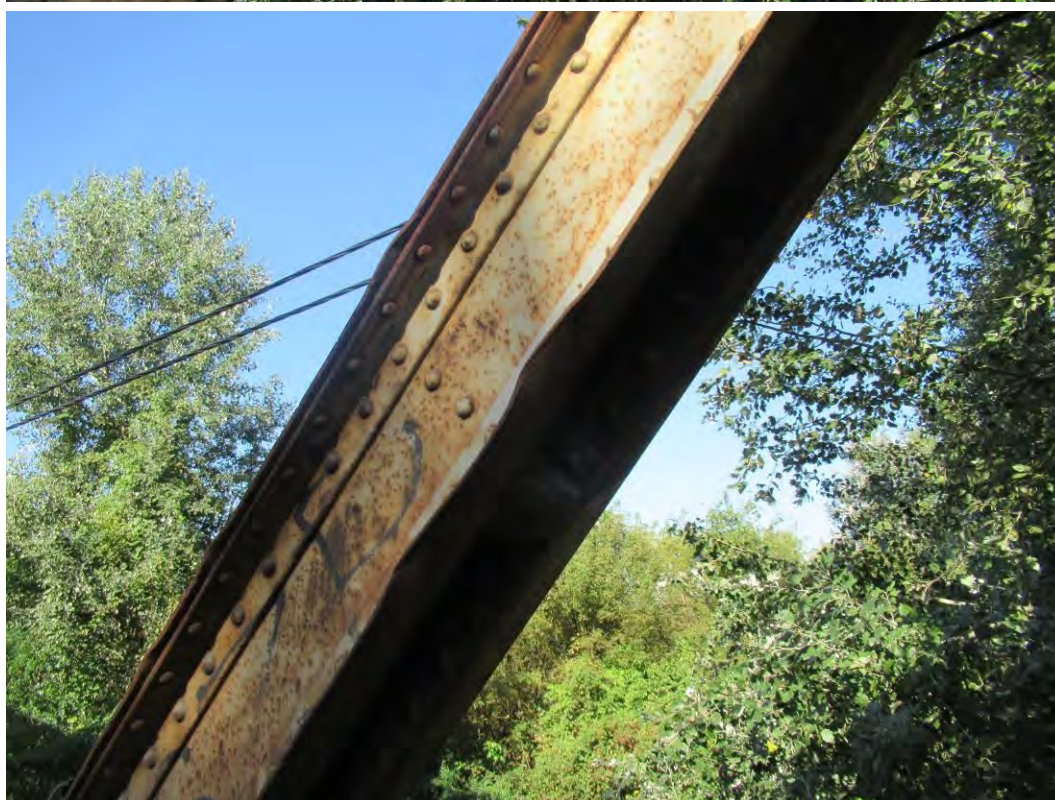
Механичка оштећења дијагонале 0-I левог решеткастог носача конструкције К2
