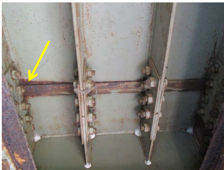
Трагови процуривања на месту монтажног наставка - поље 4'-3'
