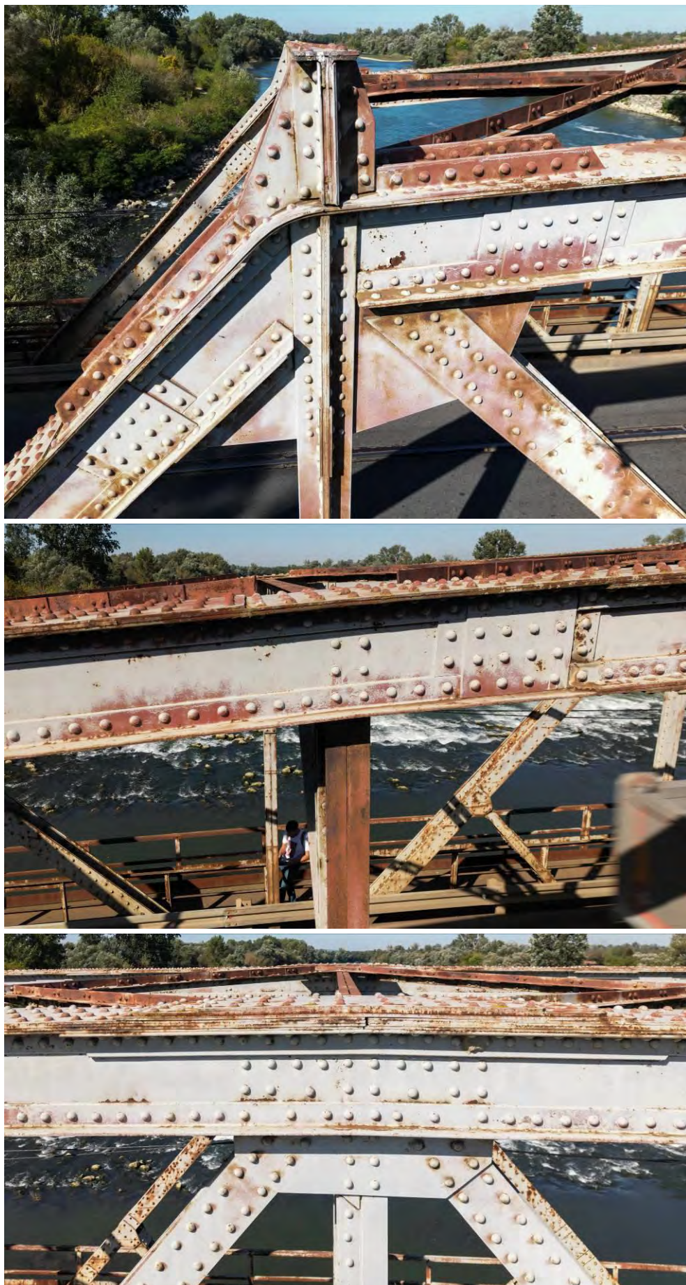
Површинска корозија бочних површина горњег појаса конструкције К3
