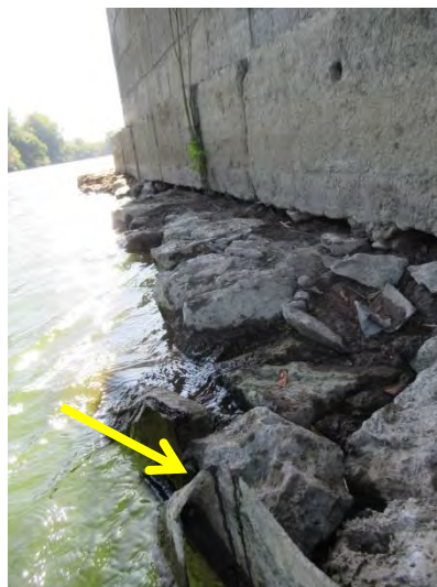
Оштећен лим око темељног проширења и деградација темеља
