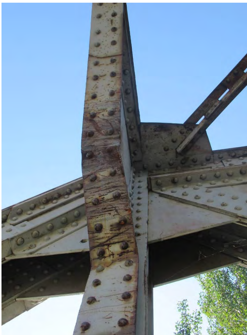
Механичко оштећење десног укрућења излазног порталног рама конструкције К2
