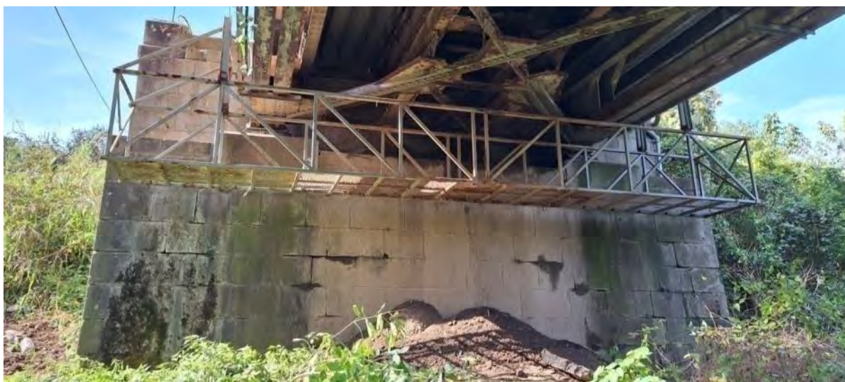
Трагови сливања воде, незапуњене фуге на телу стуба
