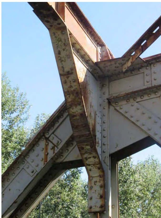
Механичко оштећење десног укрућења излазног порталног рама конструкције К1
