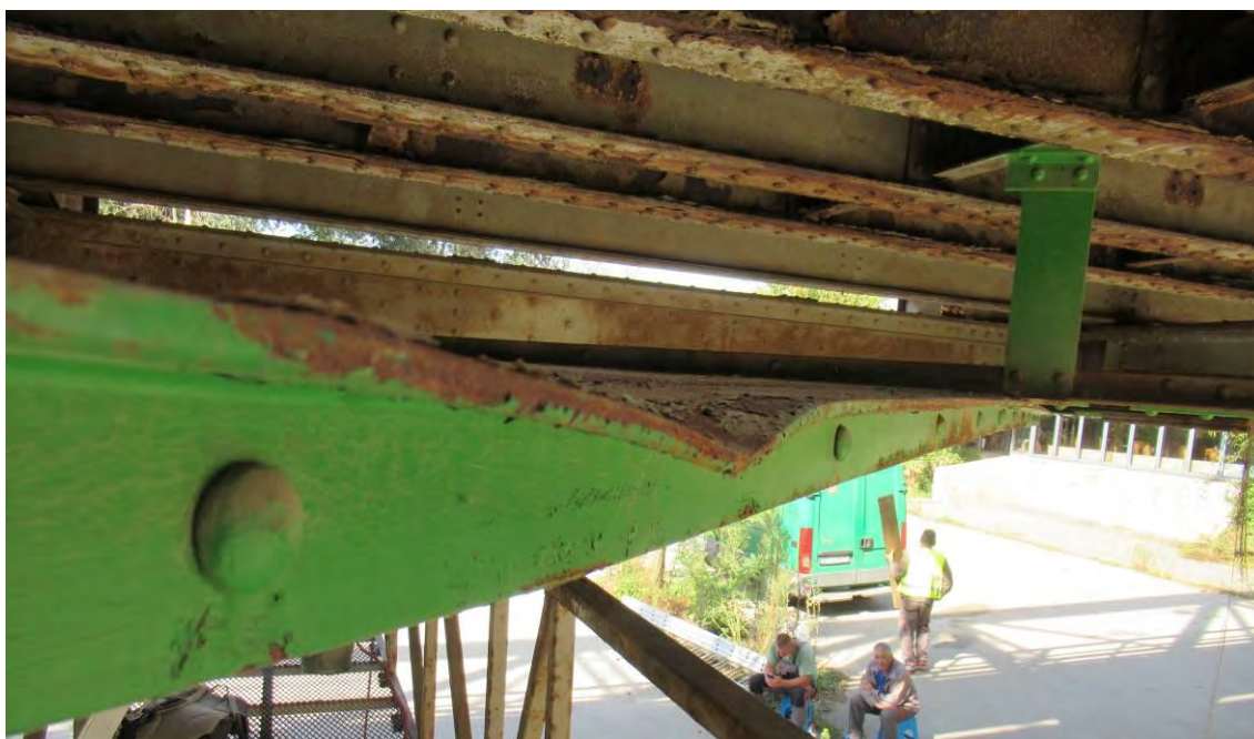
Механичко оштећење дијагонале услед удара возила у пољу 3'-2'
