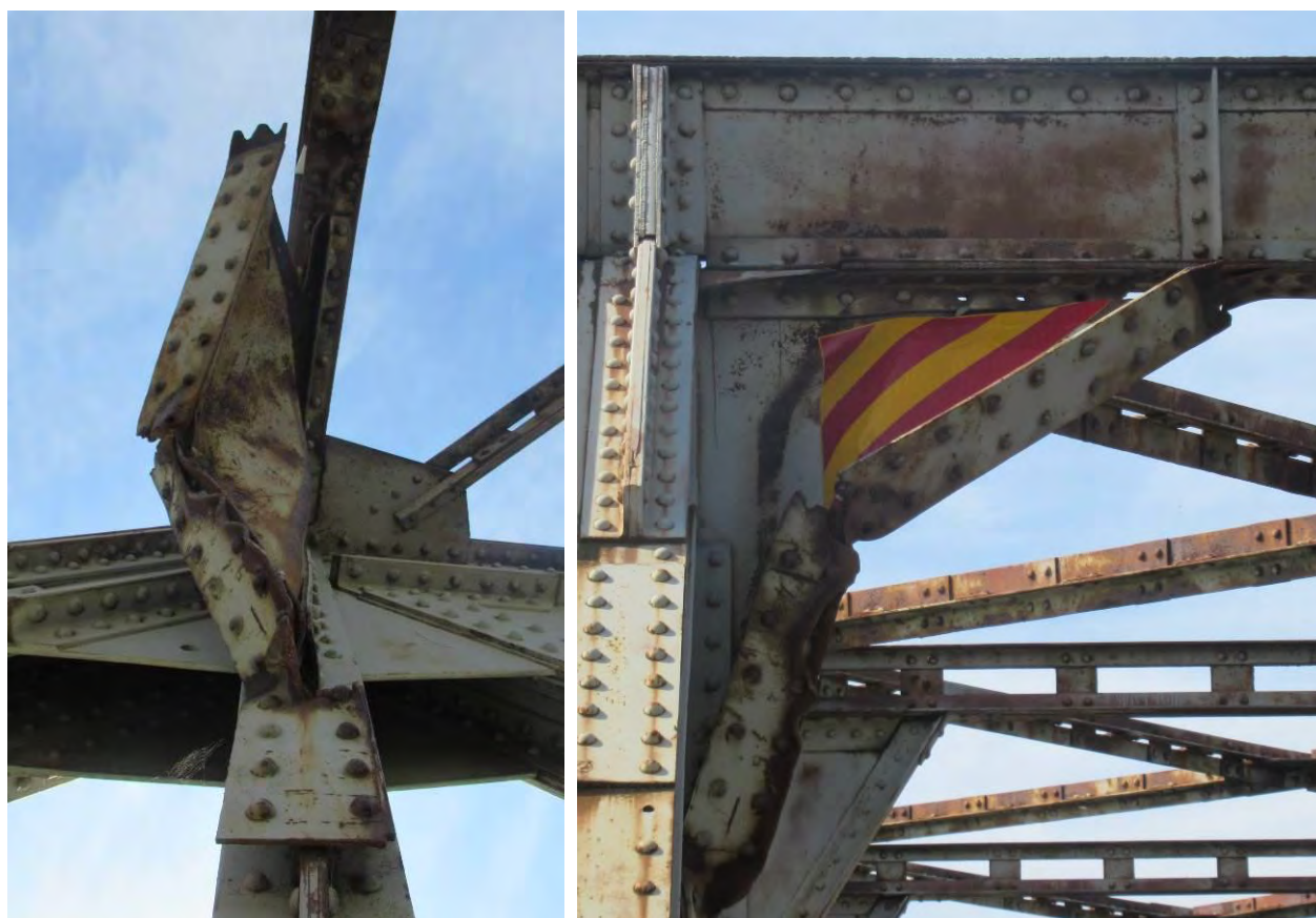
Механичко оштећење десног укрућења излазног порталног рама конструкције К3
