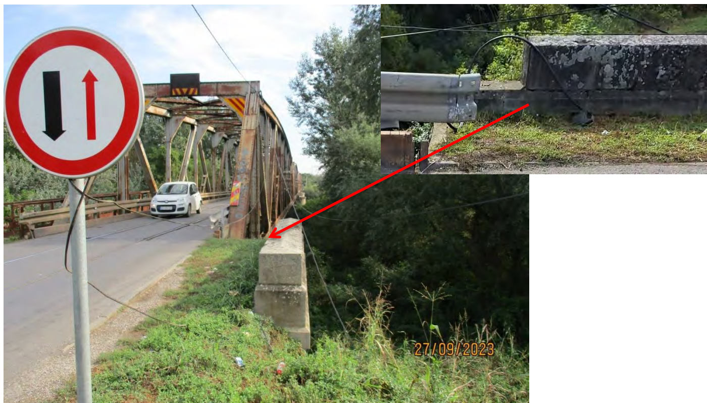
Инсталације са десне стране на почетку моста. Један кабл положен на земљу
