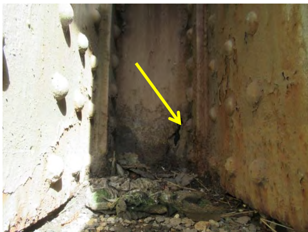
Деградација услед дубинске корозије ребра вертикале узводне решетке у чвору 2
