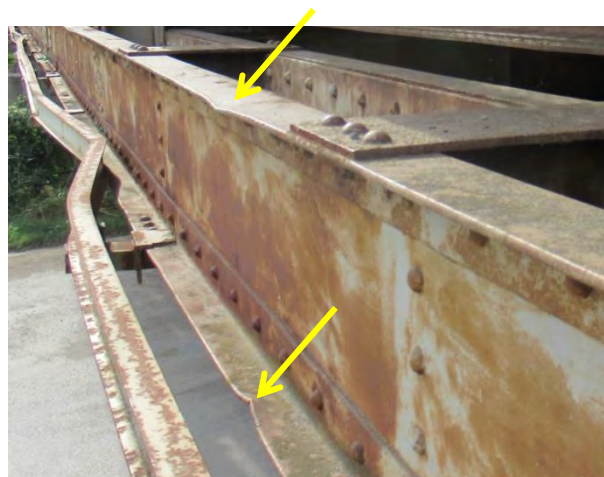
Локална деформација доње и горње ножице - узводна решетка, поље 1'-0'
