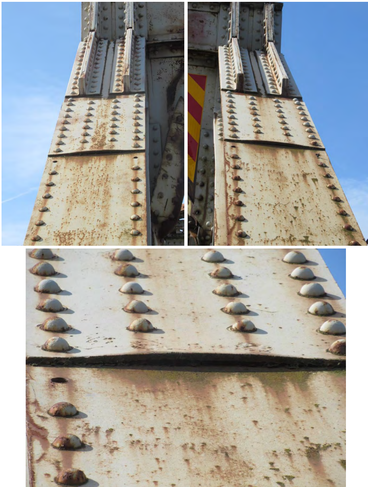
Зазор између горње ламеле и подвезице у горњем делу дијагонала I'-0' левог и десног решеткастог носача конструкције КЗ услед неуграђених заковица и неуграђене заковице испред (испод) подвезице
