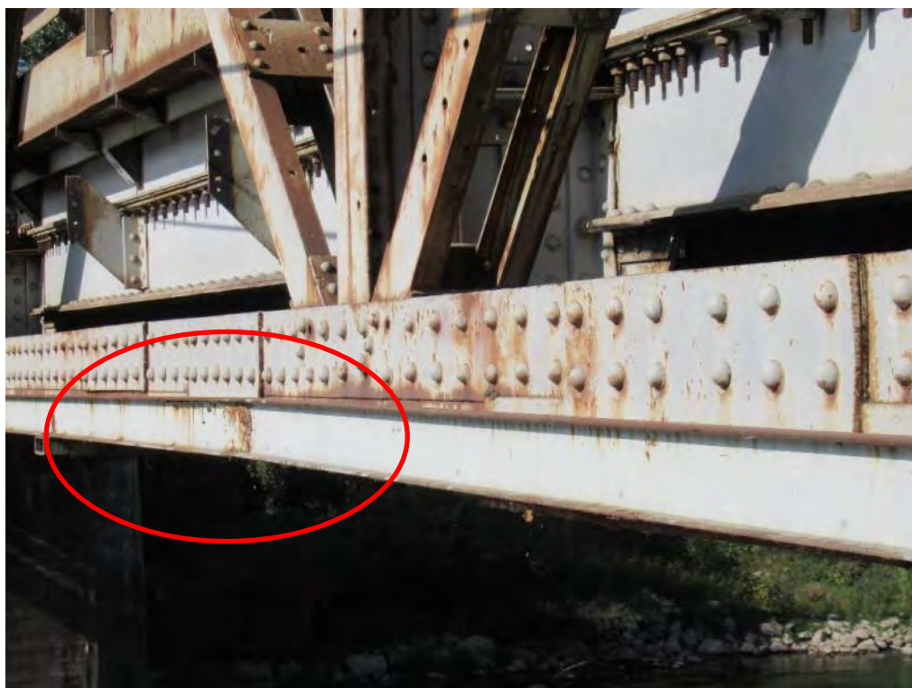
Лош монтажни наставак шине са узводне стране - лоша геометрија шине
