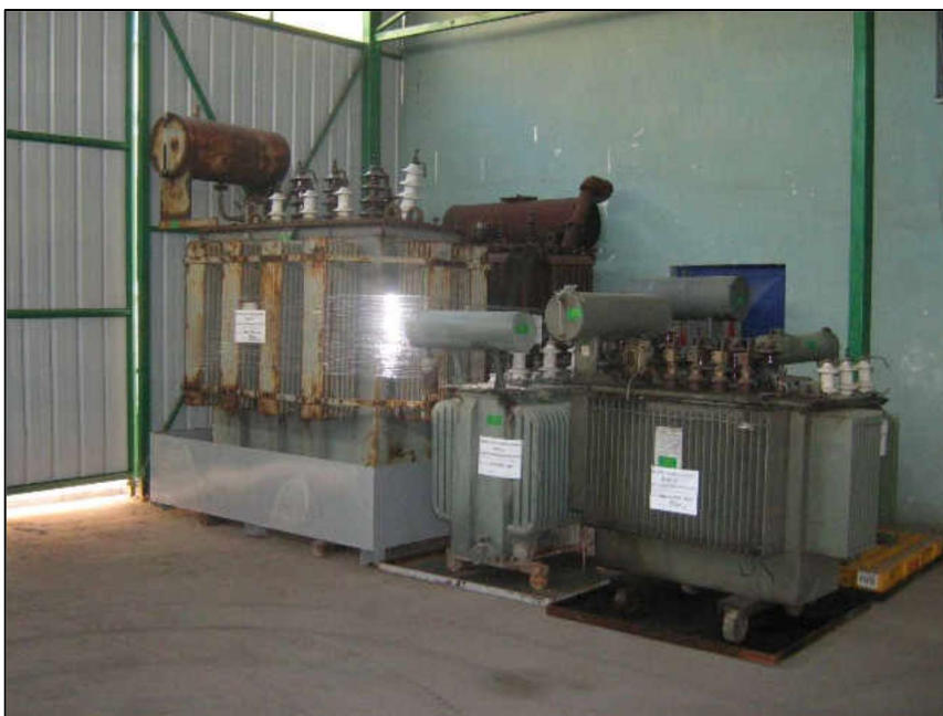
Слика 25. – Трансформатори спремни за третман одмашћивања
